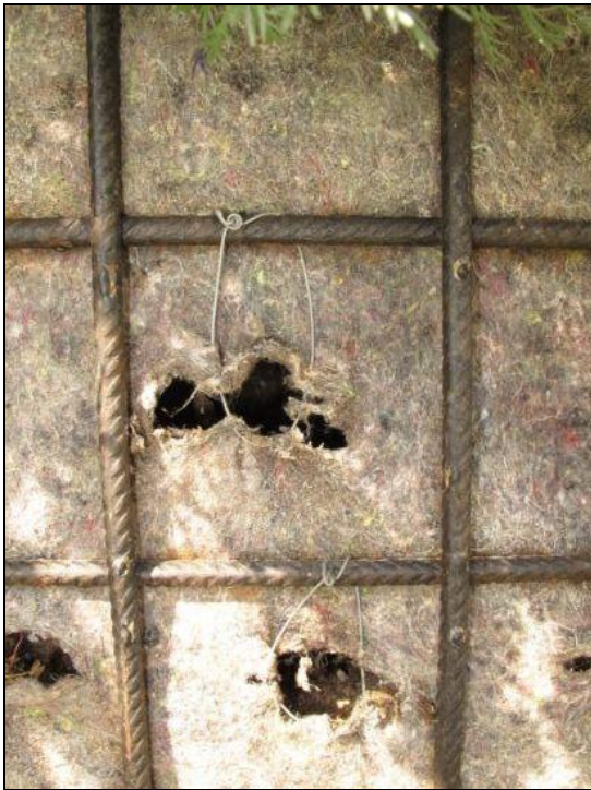
Foto 172: Detail propadu zeminy ( 22.5.2014, autor: Petra Suldovská)
