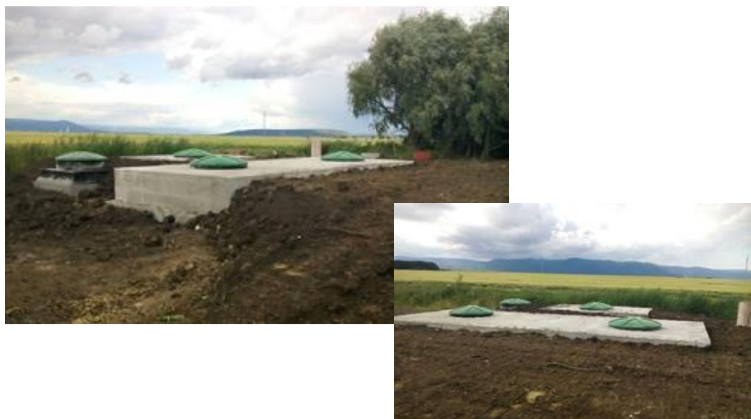
Obr. 20: Obecní ČOV Pesvice (Zdroj: Svatoš K., 2020).
