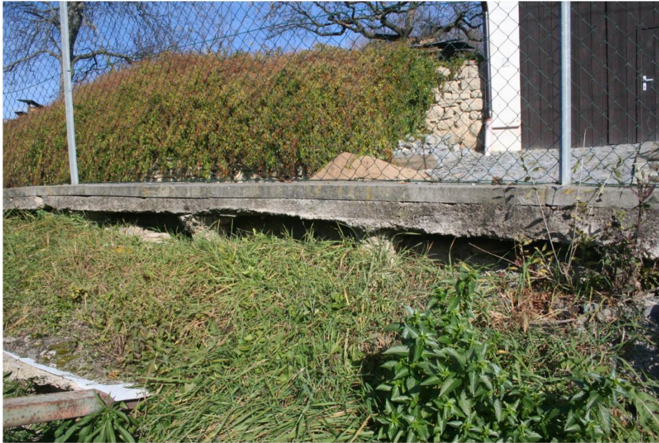
Obr. č. 2-7: Prázdný prostor vzniklý nad sesunutou zeminou [2]
