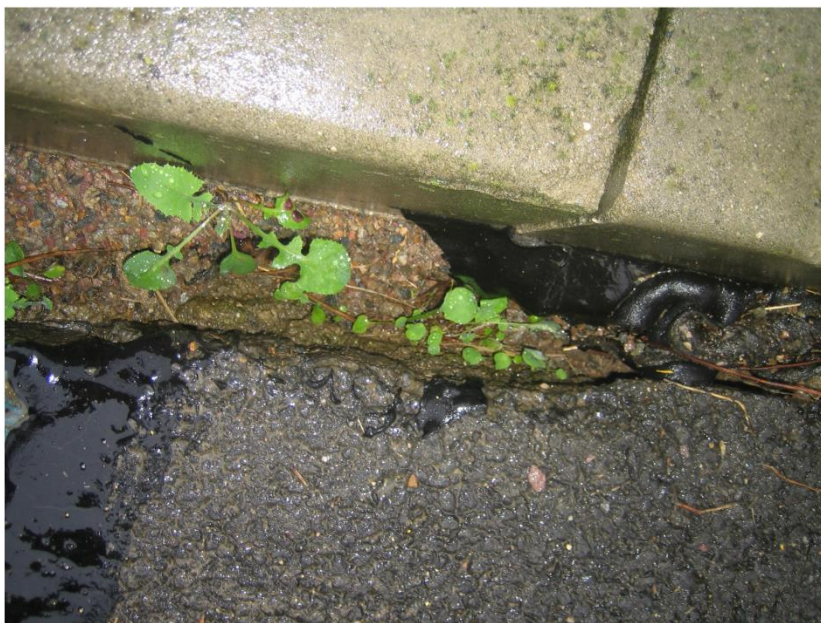
Obr. č. 2-3: Trhlina ve vozovce u obrubníku [2]
