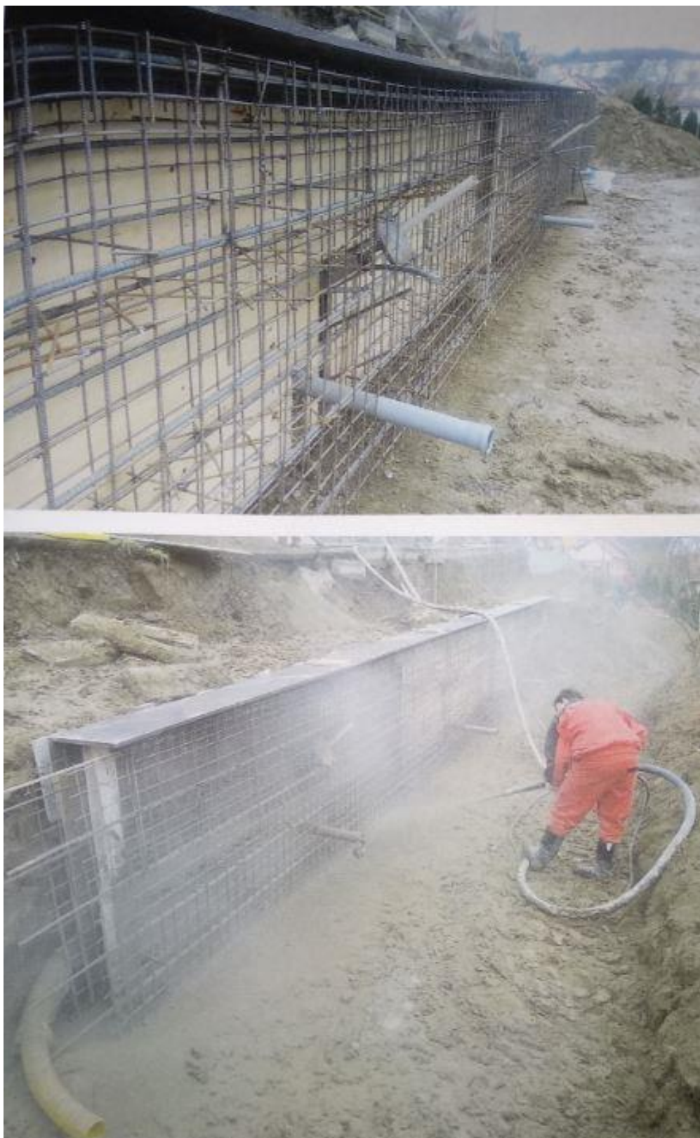
Obr. č. 5-9: Vyztužení monolitické zdi se zakotvením a drenážními vývody a následné zastříkání betonem [1]
