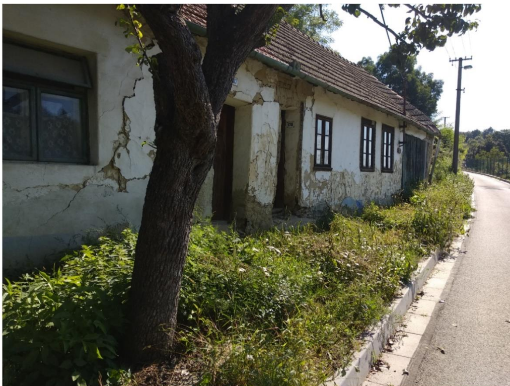
Obr. č. 6-3: Praskliny na rodinném domě z dřívějších sesuvných pohybů
