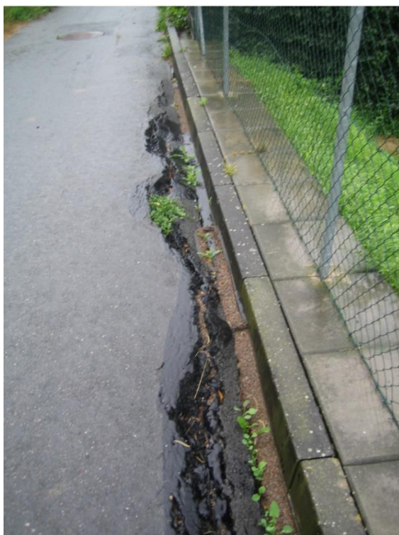
Obr. č. 2-4: Trhliny ve vozovce [2]
