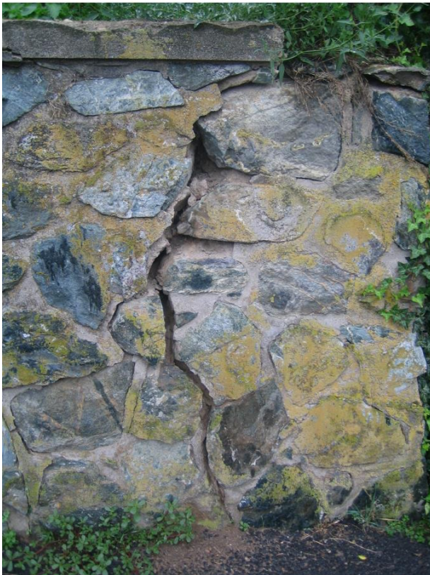
Obr. č. 2-5: Trhliny ve zdi patřící rodinnému domu u vozovky [2]
