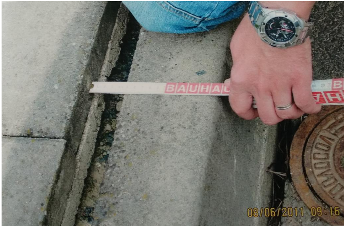
Obr. č. 2-10: Posun obrubníků u vozovky o 47 mm před RD č. 166 [1]
