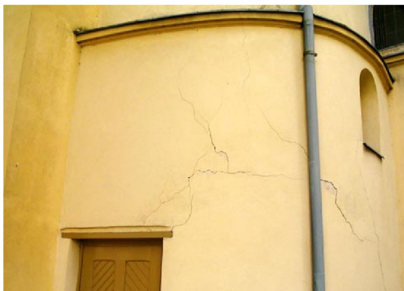
Obr. A.2.2 Příklad poškození objektu vystavené seismickému zatížení [117]
