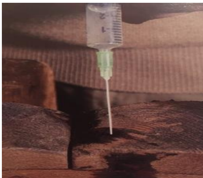
Obrázek 2 - Vpravení do otvorů po červotoči insekticidní prostředek za pomoci injekční stříkačky (Vigué, 2010)
