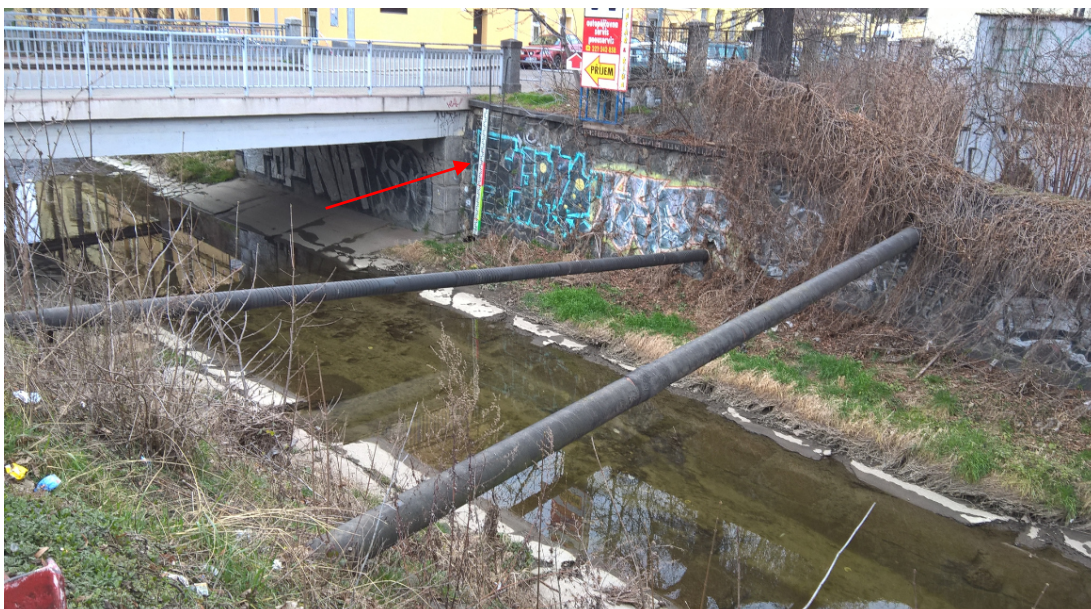
Příloha č. 19 Inženýrské sítě u Divadla Na Fidlovačce vedené v korytě toku, které při pohledu po proudu se kříží a u pilře mostu je vidět vodočetná lať. (autor, 2015)
