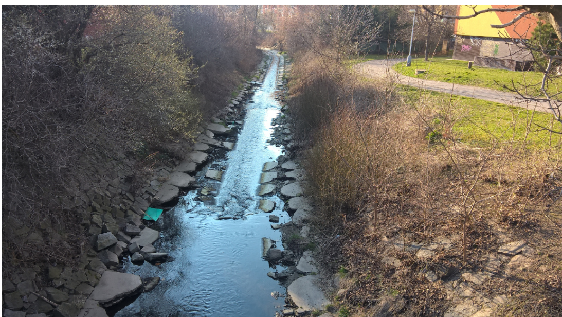
Příloha č. 21 Poničené opevnění koryta mezi dlažbou a panely v úseku mezi ulicí Michelská a vlakovým nádražím, pohled z lávky po proudu. (autor, 2015)
