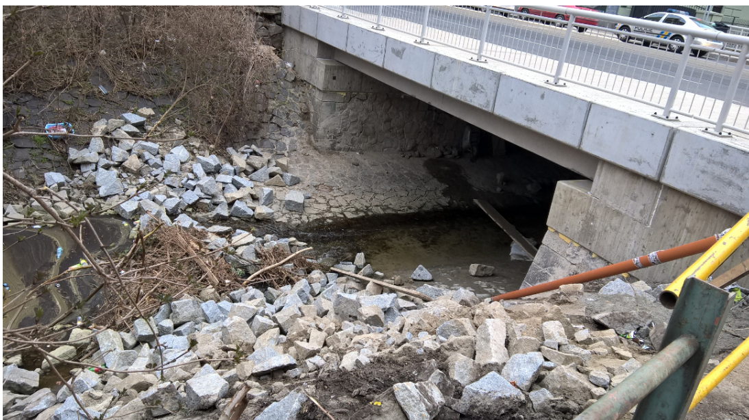
Příloha č. 20 Před mostem v Bělehradské ulici je nasypaná suť v korytě toku a zabraňuje proudění vody v korytě toku. (autor, 2016)
