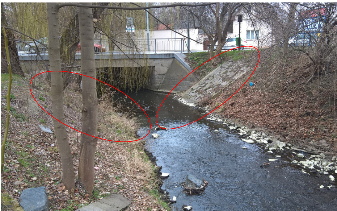
Příloha č. 28 Vyznačená přeložka potrubí před mostem v ulici K Horkám, která snižuje průtočnou plochu koryta toku. (autor, 2015)
