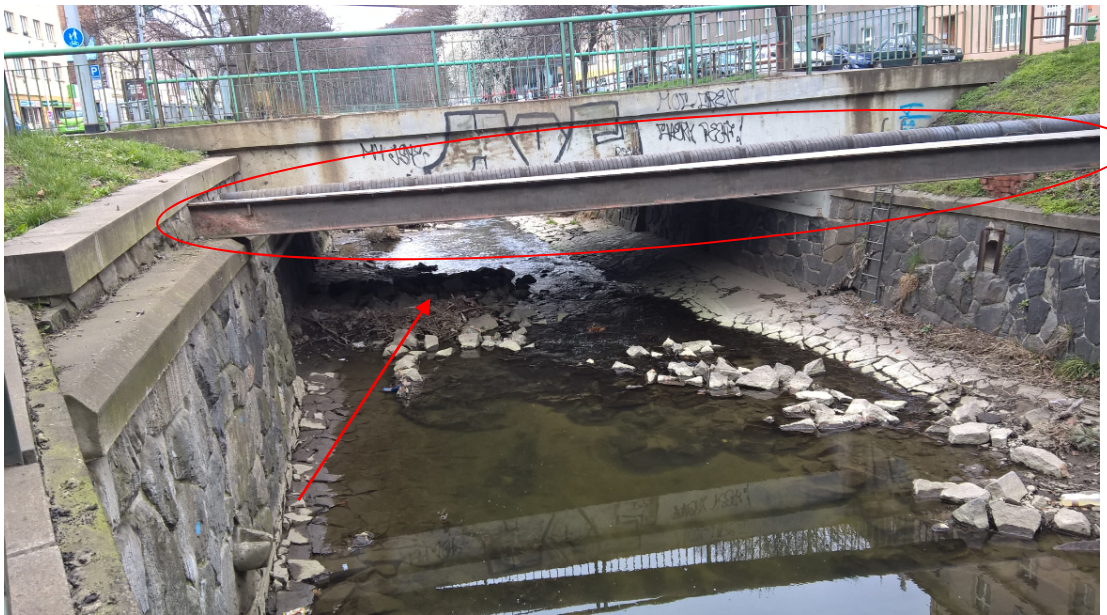
Příloha č. 17 Most v ulici Na Folimance, kde je vidět z druhé strany, kde je označená inženýrská síť, která je chráněna I-profilem a naplaveniny v korytě toku. (autor, 2016)
