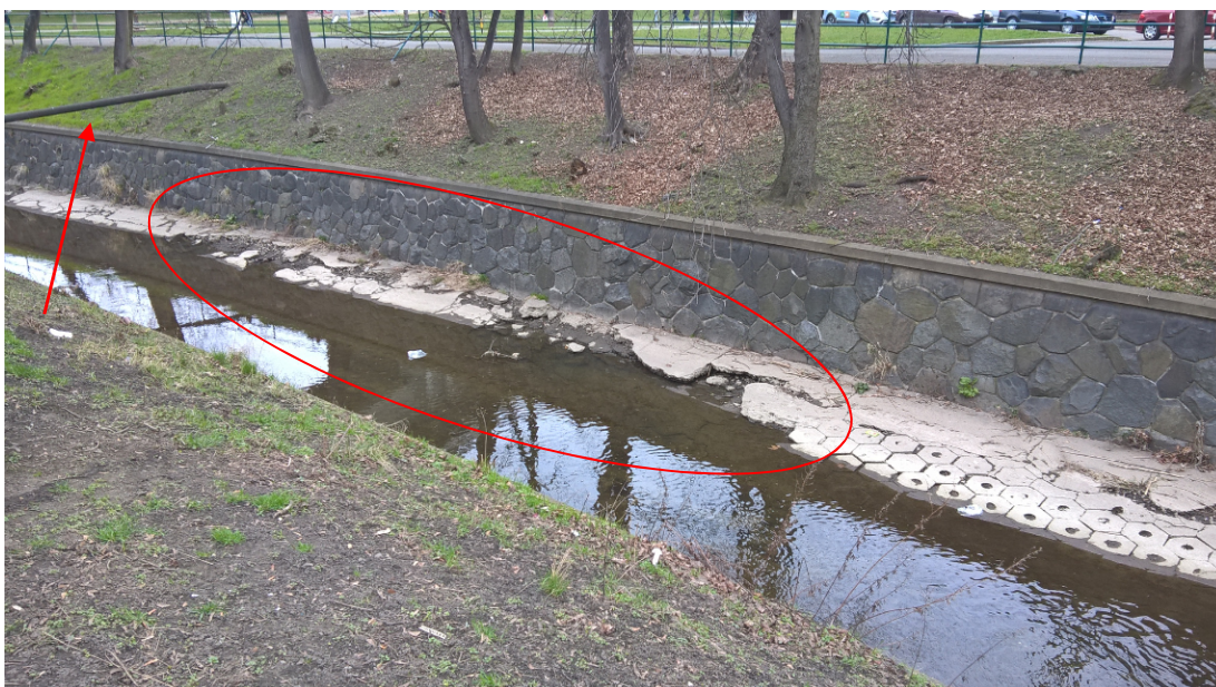
Příloha č. 15 Na snímku u sportovní haly Folimanka je označena inženýrská síť vedená v korytě toku a poničené opevnění dna koryta toku. (autor, 2015)
