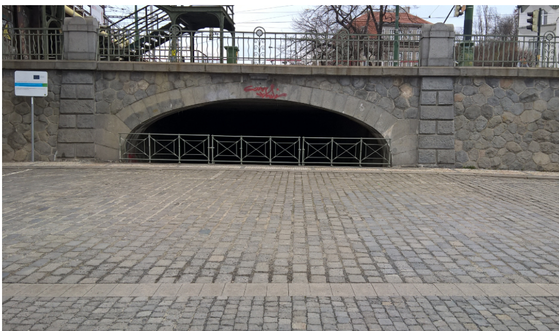
Příloha č. 13 Vyústění Botiče na náplavce, kde most se zábradlím omezuje plynulé proudění vody do Vltavy. (autor, 2015)
