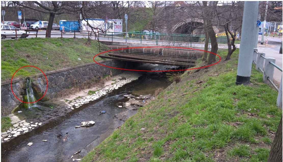
Příloha č. 16 U mostu v ulici Na Folimance je označené špatné zaslepení potrubí vedené do toku a také další inženýrské sítě. (autor, 2016)
