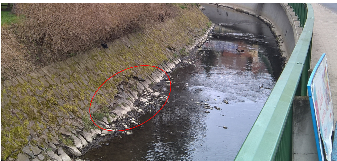
Příloha č. 23 Snímek z ulice Záběhlická na porušené opevnění koryta. (autor, 2015)
