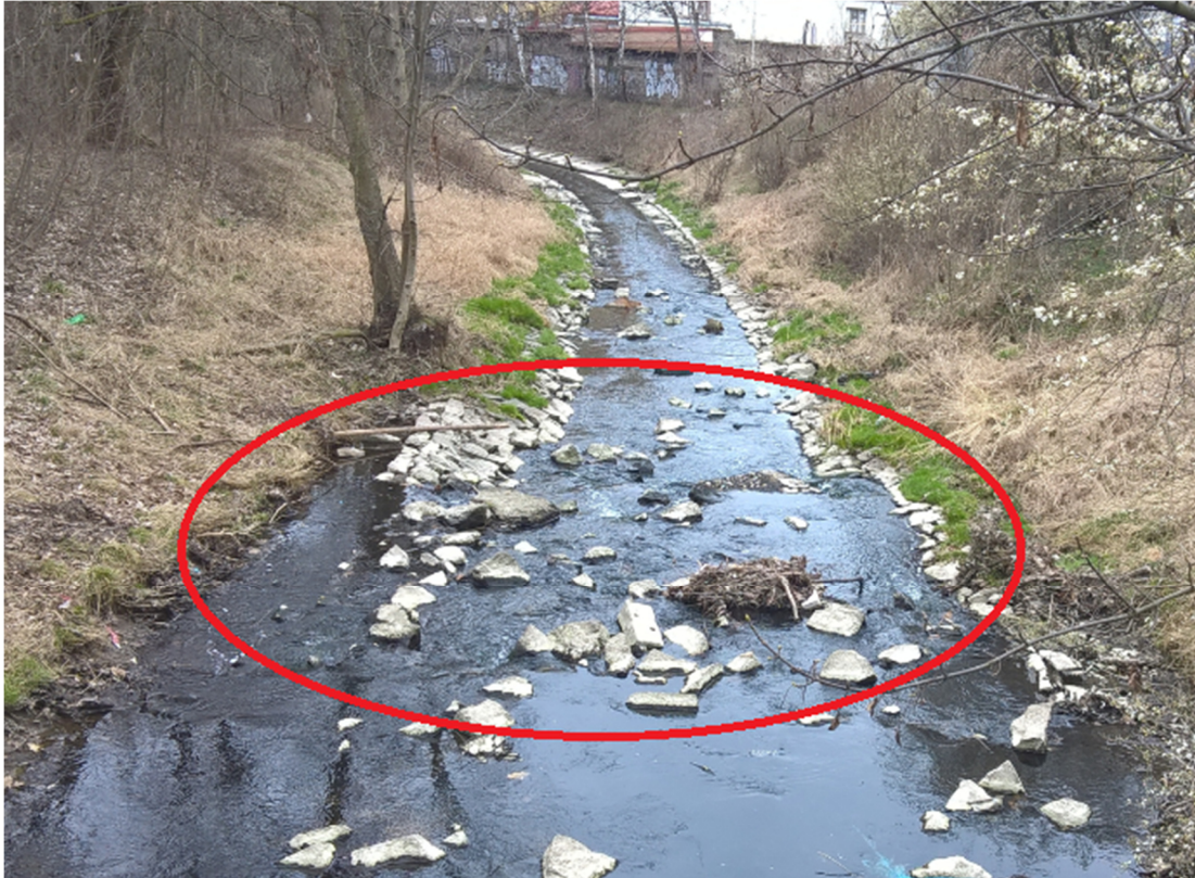
Obr. č. 12 Na snímku je vidět zničený stupeň ve dně, který by měl být nahrazen skluzem, foceno po proudu toku. (autor, 2015)
