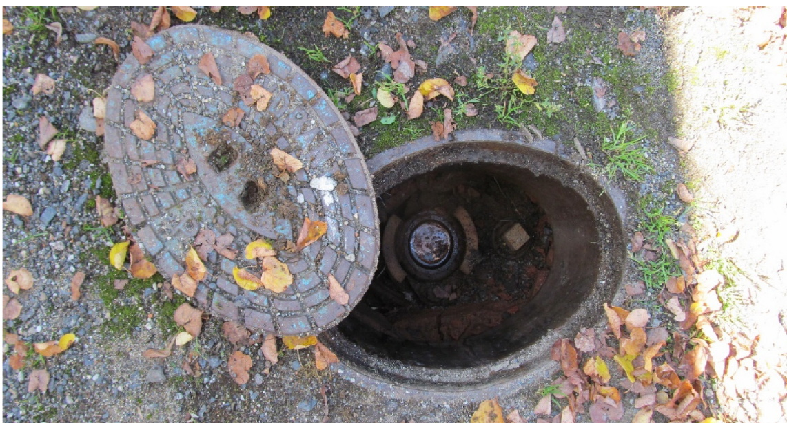
Obr. 28 Fotografie otevřeného podzemního hydrantu zařazeného do kategorie K2.
