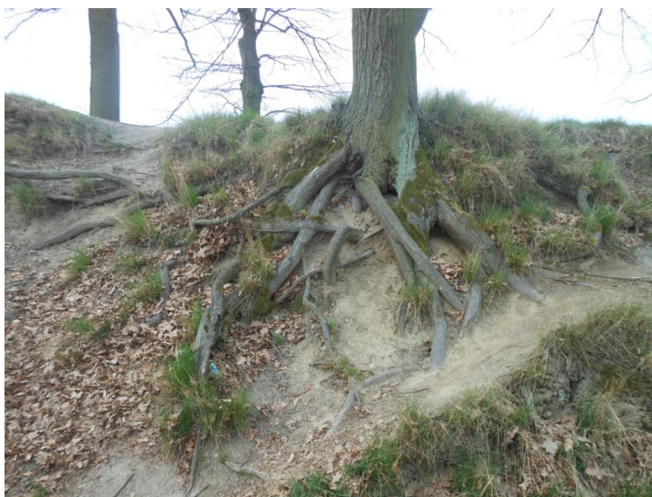
OBR. 24. : Obnažené kořeny na vzdušné straně hráze
