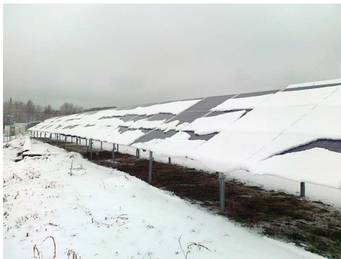
Obr. č. 17 FVE v zimě ( http://www.cechura-elektro.cz/cisteni-a-udrzba-fotovoltaickych-elektren.htm )
