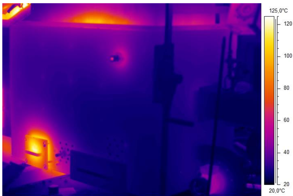
Obr. 16: Termogram spalovací jednotky GEMOS Ekogem S v provozu
