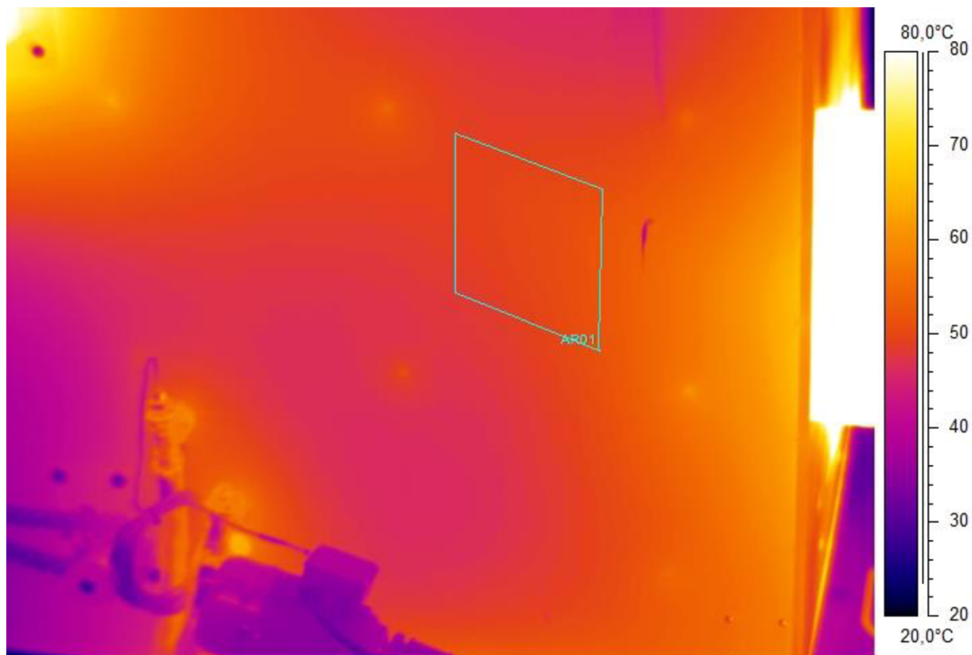
Obr. 25: Termogram zadní stěny kotle se zapnutým přívodem sekundárního vzduchu
