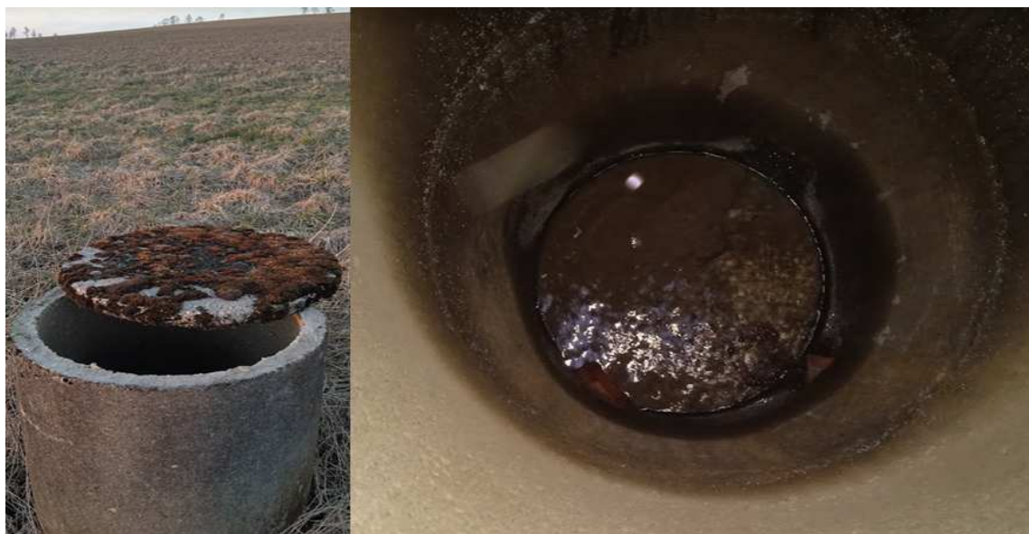
Obrázek 2 – Spojovací šachta drenážního systému (autor)
