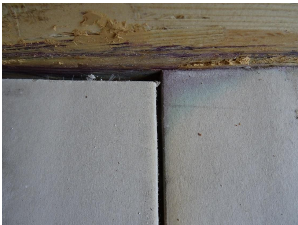
Obrázek 44 – Dolní sádrovláknité desky a průnik vody v místě spáry
