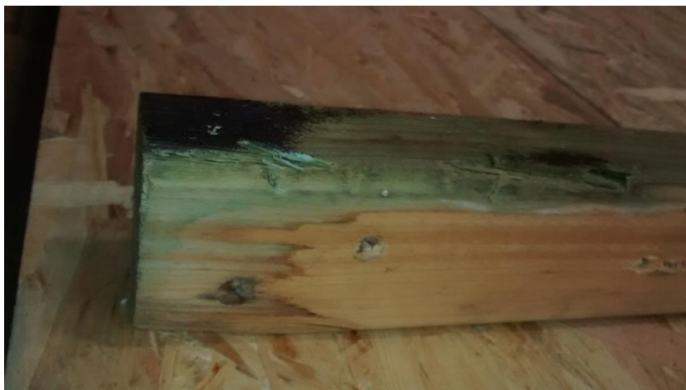
Obrázek 60 – Degenerace nosných trámů působící vlhkostí
