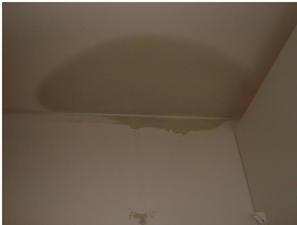
Obrázek 18 – Interiér po vlhkostní havárii [14]
