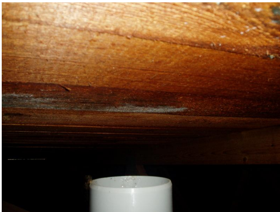
Obrázek 13 – Dřevo napadené plísní v důsledku vlhkosti [10]
