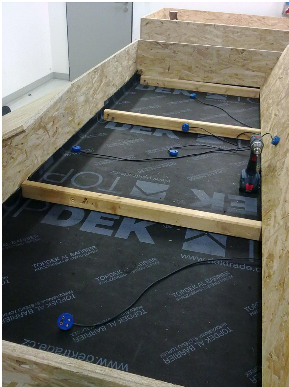
Obrázek 21 – Nosné trámy stropu, OSB záklop, vlhkostní čidla
