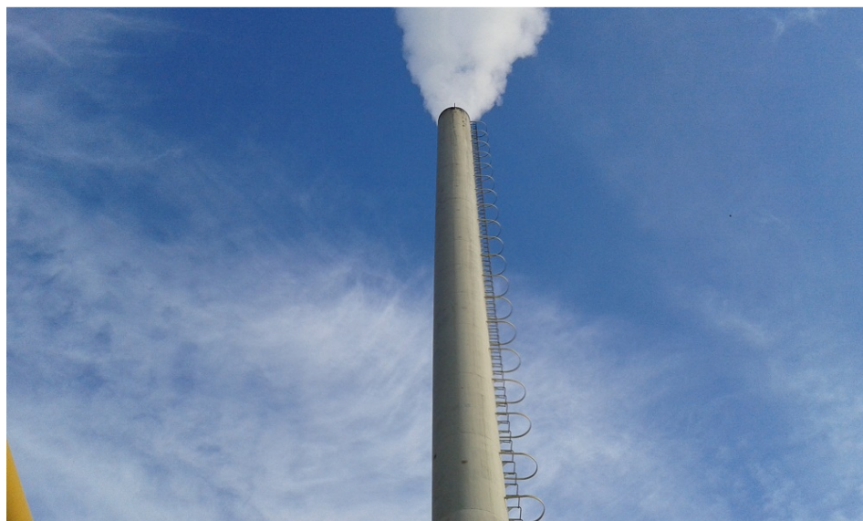
Obr.č.8 Foto B601 – vypouštěné CO 2 mísené vzduchem
