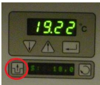
Obrázek 10: Ovládací panel teplotně stabilizačního zařízení
