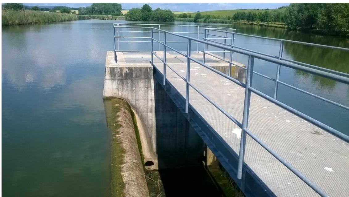
Obr. 17 – vodní nádrž 18. 6. 2014 – nulový přepad vody přes přeliv
