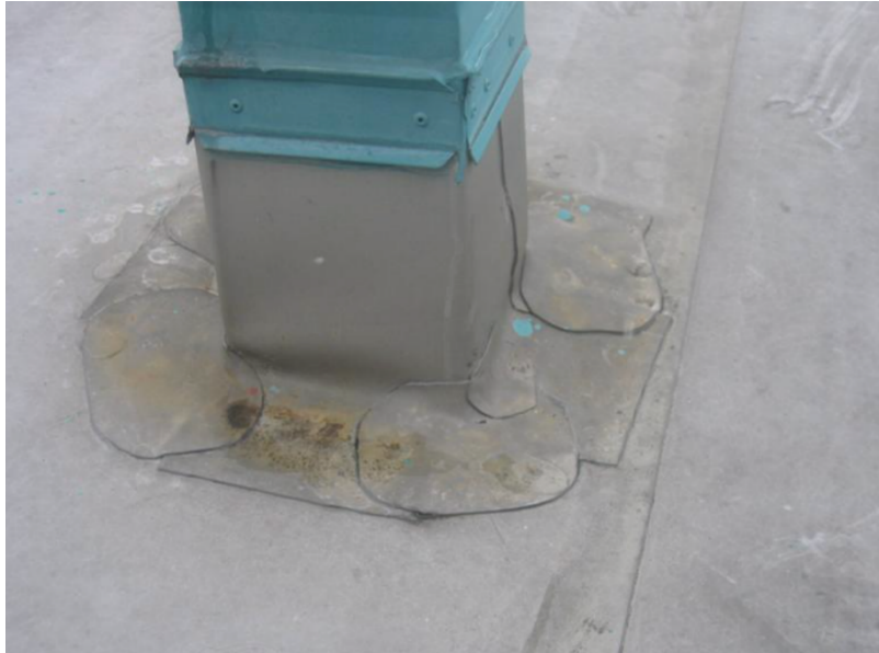
Obr. 17 Chybné provedení detailu připojení hydroizolace na komín [11]
