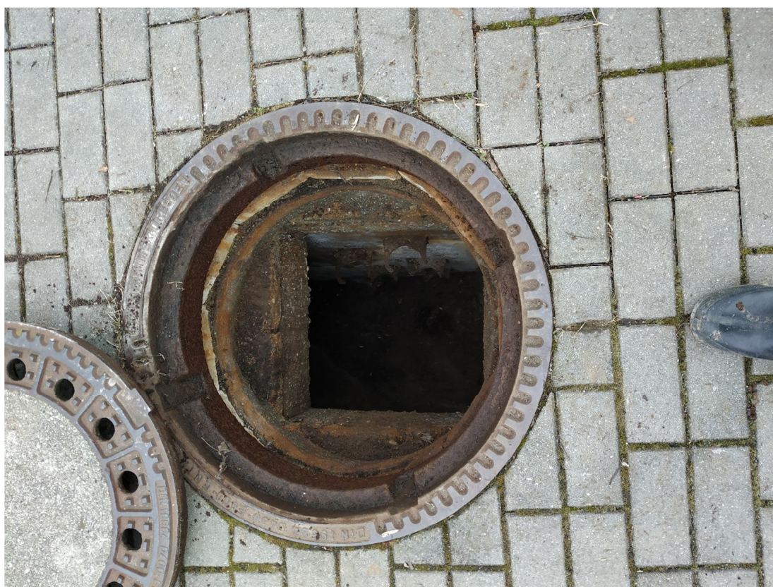
Obrázek 50: snímek zachycující zkorodovaná stupadla v OK 19 (Loděnice), (vlastní foto, 2021)
