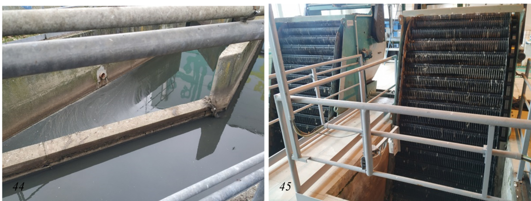
Obrázek 44, 45: Přepadová hrana na nátoky před ČOV, (vlastní foto, 2021); Česle na odlehčení v areálu ČOV, (vlastní foto, 2021)
