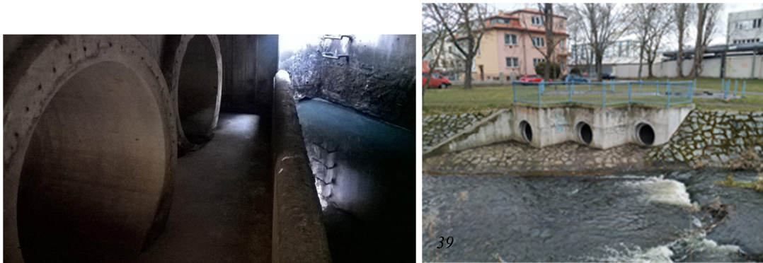
Obrázek 38, 39: Odlehčovací komora OK25, přepadová hrana ( vlastní foto, 2021 ); Vyústění z OK25, ( vlastní foto, 2021 )
