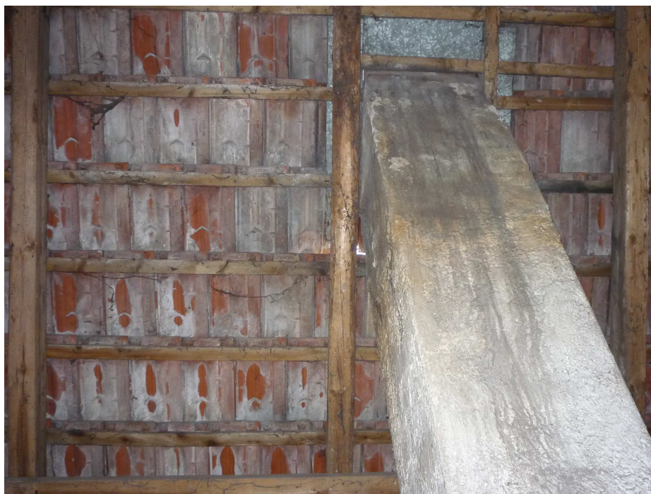
Příloha č. 22 Žluté až hnědé skvrny na plášti komínového tělesa (Zdroj: autor, 2016)
