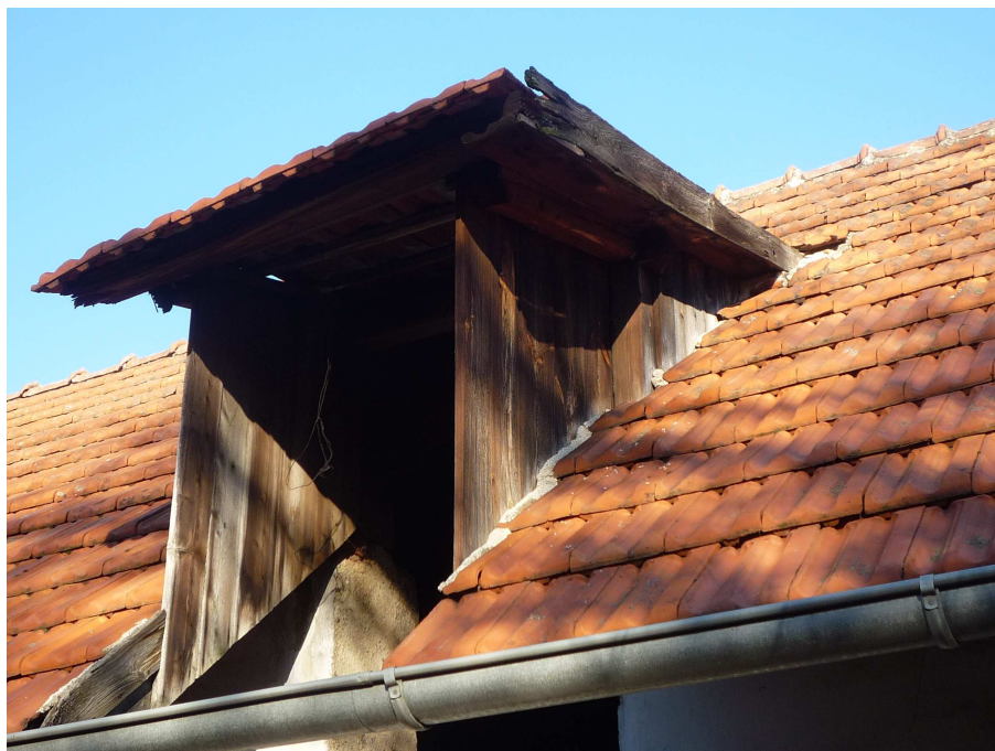
Příloha č. 21 Absence oplechování vikýře (Zdroj: autor, 2016)
