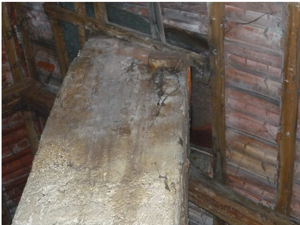
Příloha č. 15 Zkorodované oplechování komínů (Zdroj: autor, 2016)
