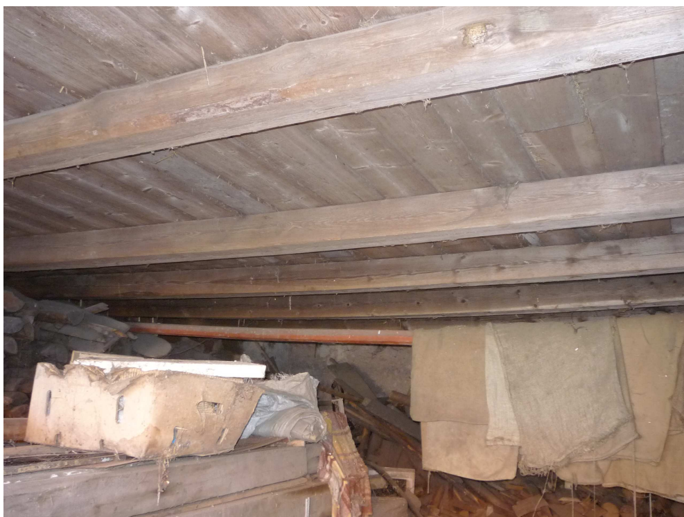
Příloha č. 4 Průhyb stropních trámů (Zdroj: autor, 2016)
