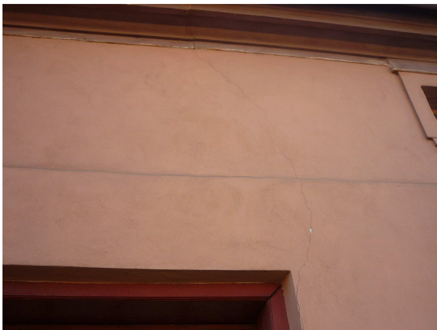
Příloha č. 28 Trhliny ve fasádě (Zdroj: autor, 2016)
