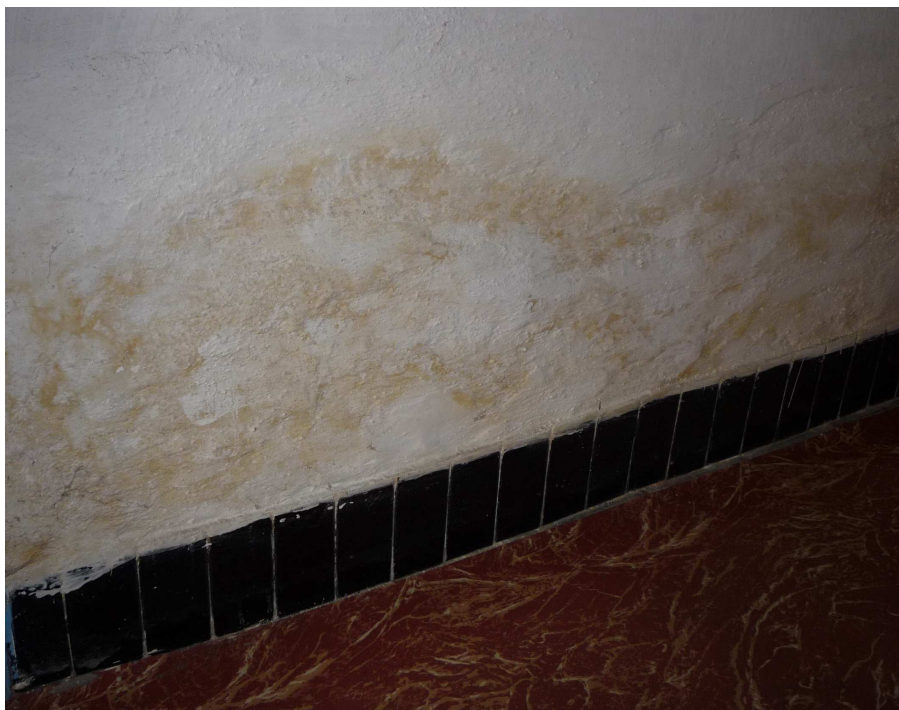
Příloha č. 2 Následek chybějící hydroizolace (Zdroj: autor, 2016)
