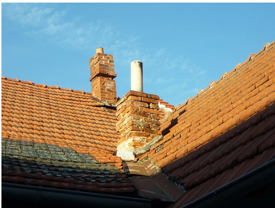
Příloha č. 16 Zkorodované úžlabí (Zdroj: autor, 2016)
