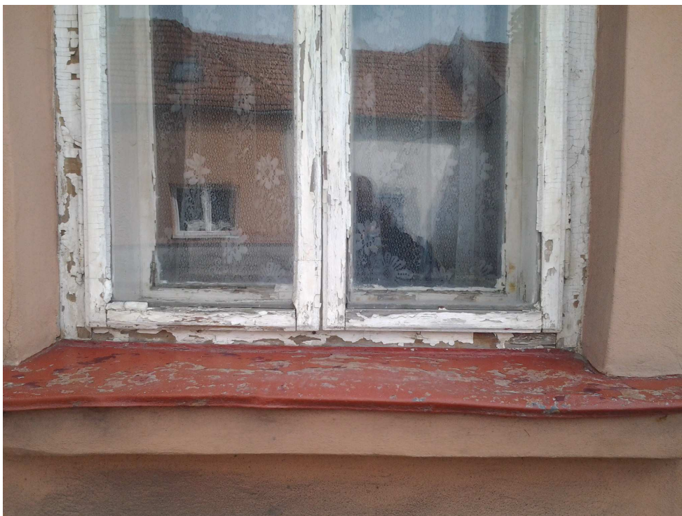
Příloha č. 27 Průhyb a rozvolnění spojů okenních křídel (Zdroj: autor, 2016)
