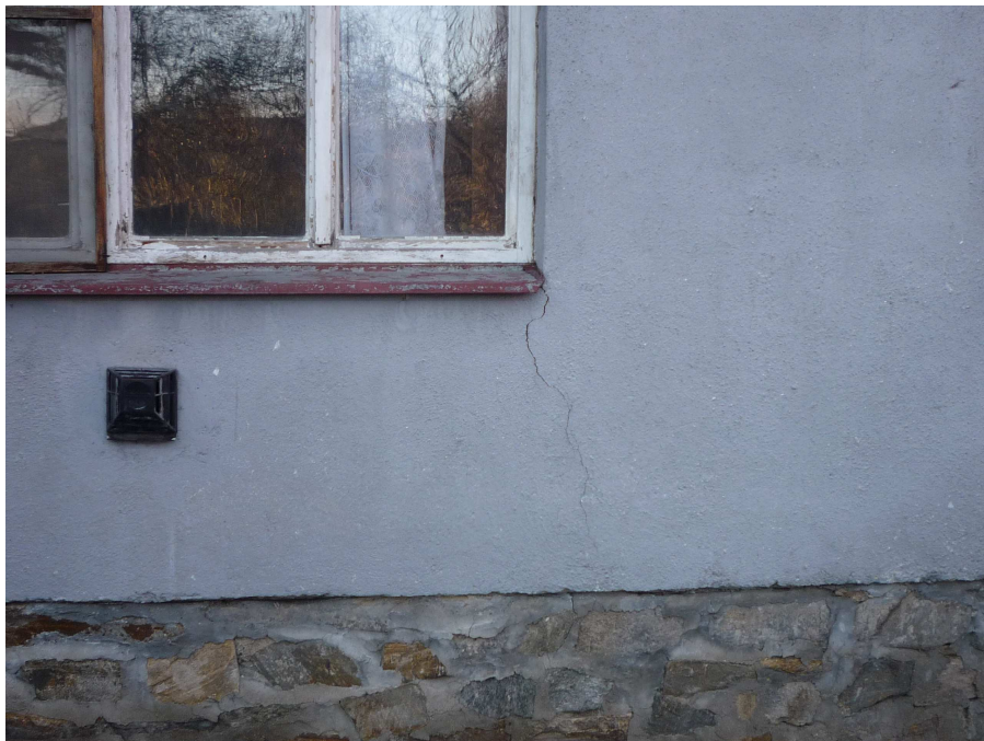
Příloha č. 1 Trhlina naznačující pohyb základů (Zdroj: autor, 2016)
