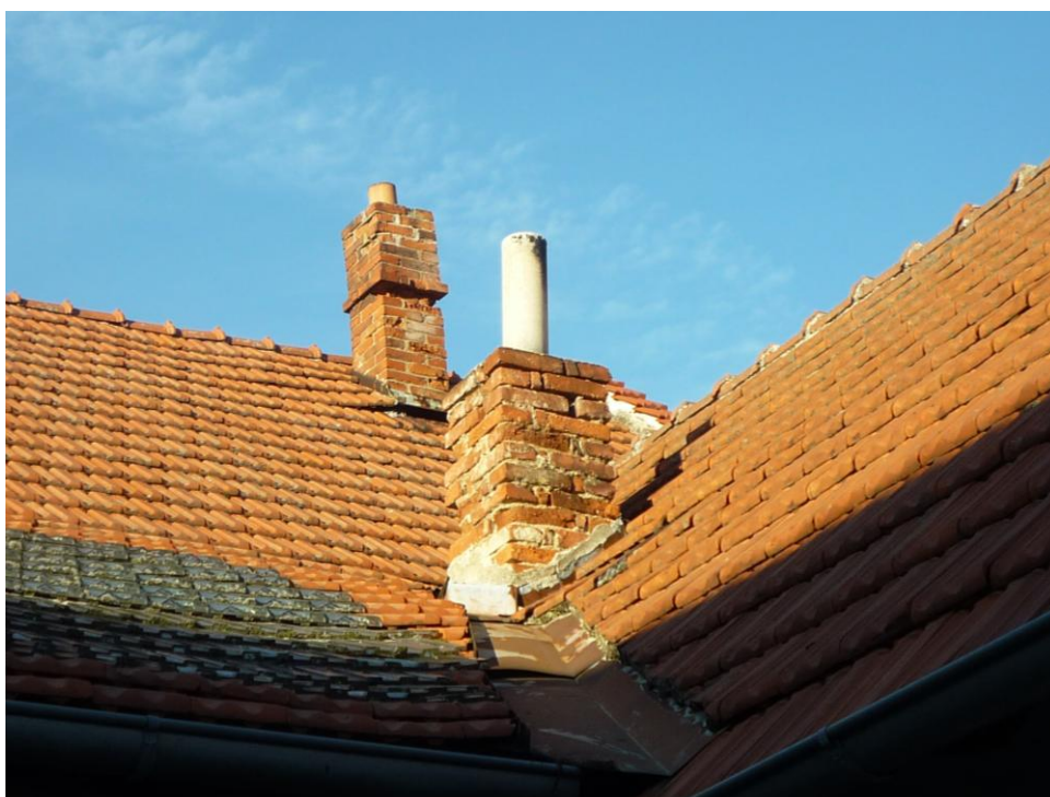
Příloha č. 16 Zkorodované úžlabí (Zdroj: autor, 2016)
