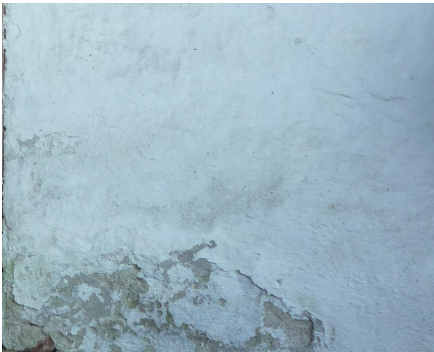
Příloha č. 25 Zdivokaz na omítce (Zdroj: autor, 2016)
