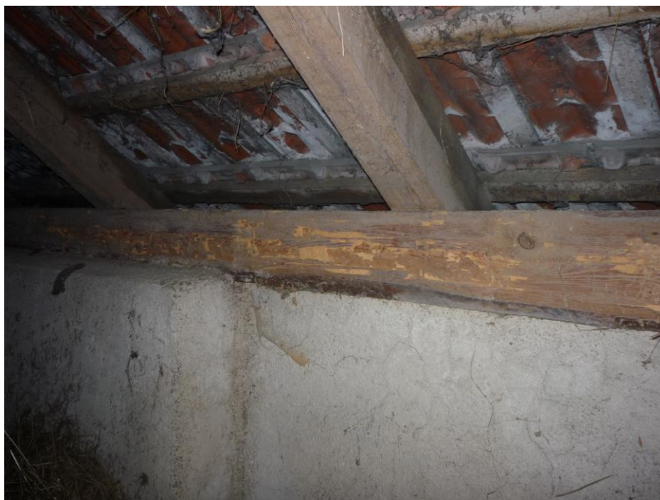
Příloha č. 13 Pozednice napadená tesaříkem krovovým (Zdroj: autor, 2016)
