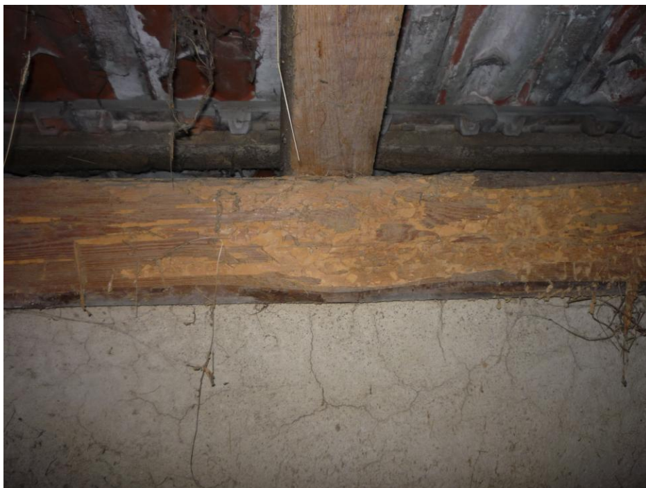
Příloha č. 9 Pozednice napadená tesaříkem krovovým (Zdroj: autor, 2016)
