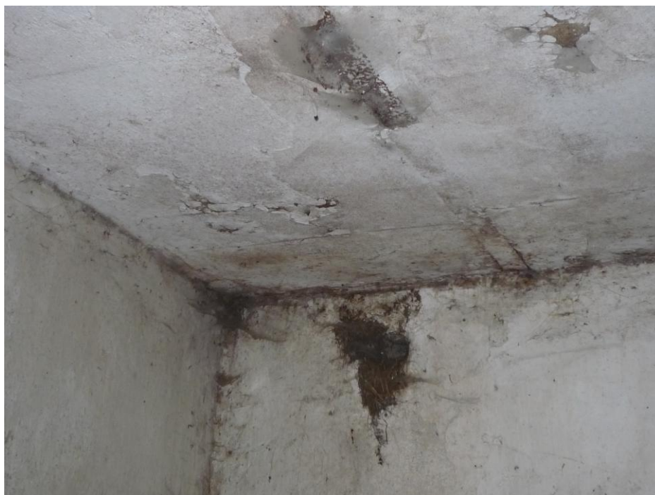
Příloha č. 7 Opadaná a popraskaná omítka na stropě (Zdroj: autor, 2016)
