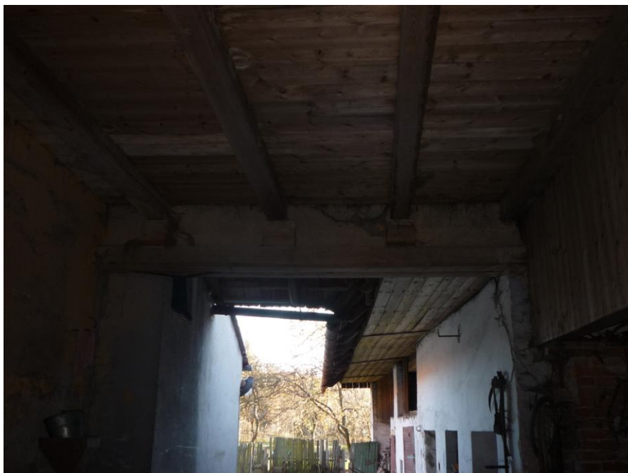
Příloha č. 5 Prohnuté průvlaky (Zdroj: autor, 2016)
