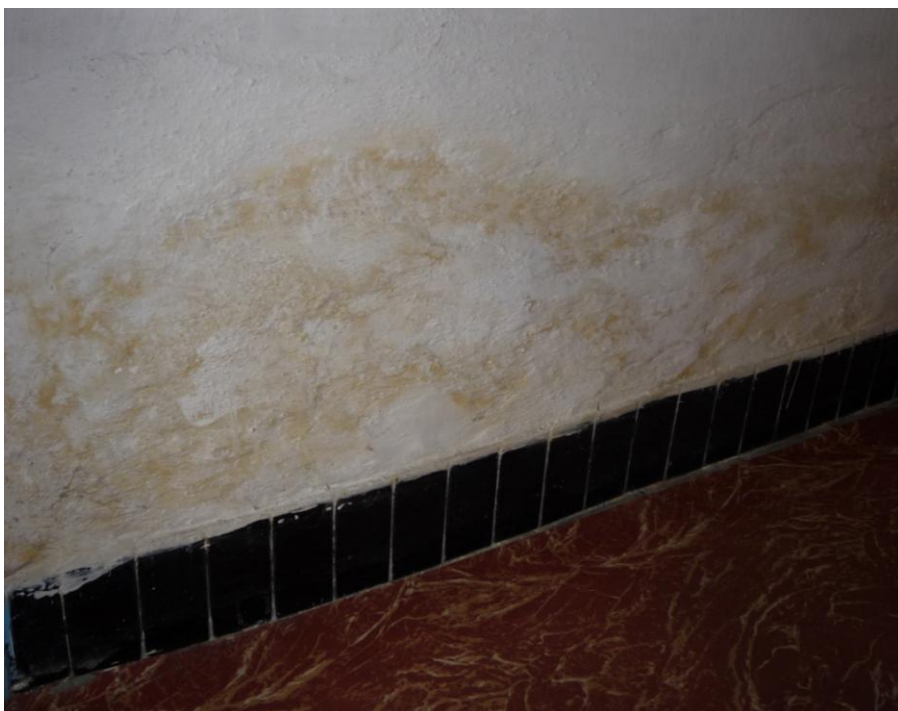
Příloha č. 2 Následek chybějící hydroizolace (Zdroj: autor, 2016)
