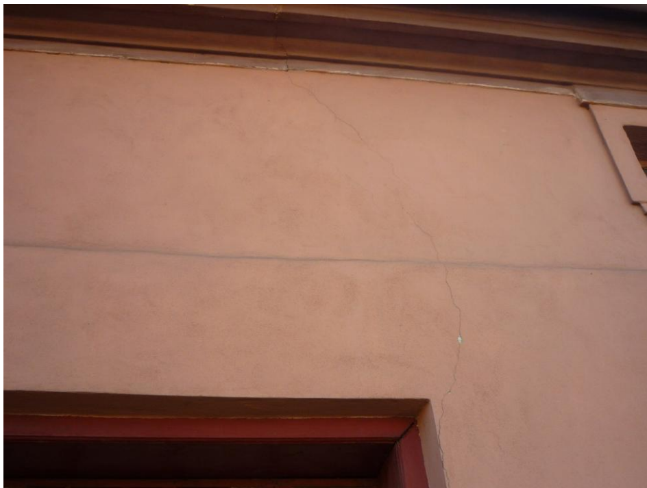
Příloha č. 3 Trhliny na nosných zdech (Zdroj: autor, 2016)
