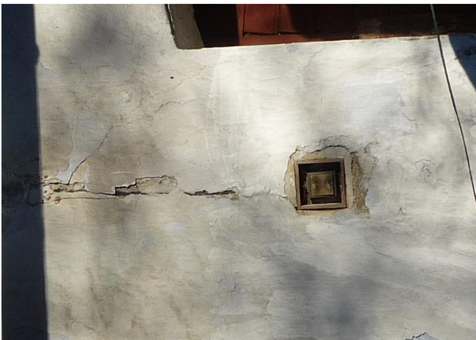
Příloha č. 26 Špatný stav elektroinstalace (Zdroj: autor, 2016)
