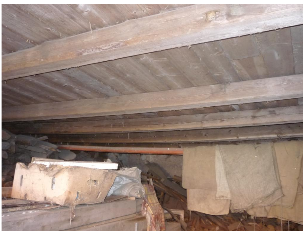
Příloha č. 4 Průhyb stropních trámů (Zdroj: autor, 2016)
