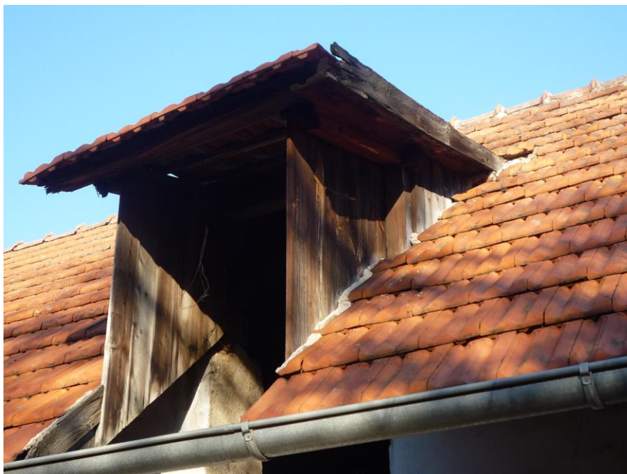
Příloha č. 21 Absence oplechování vikýře (Zdroj: autor, 2016)
