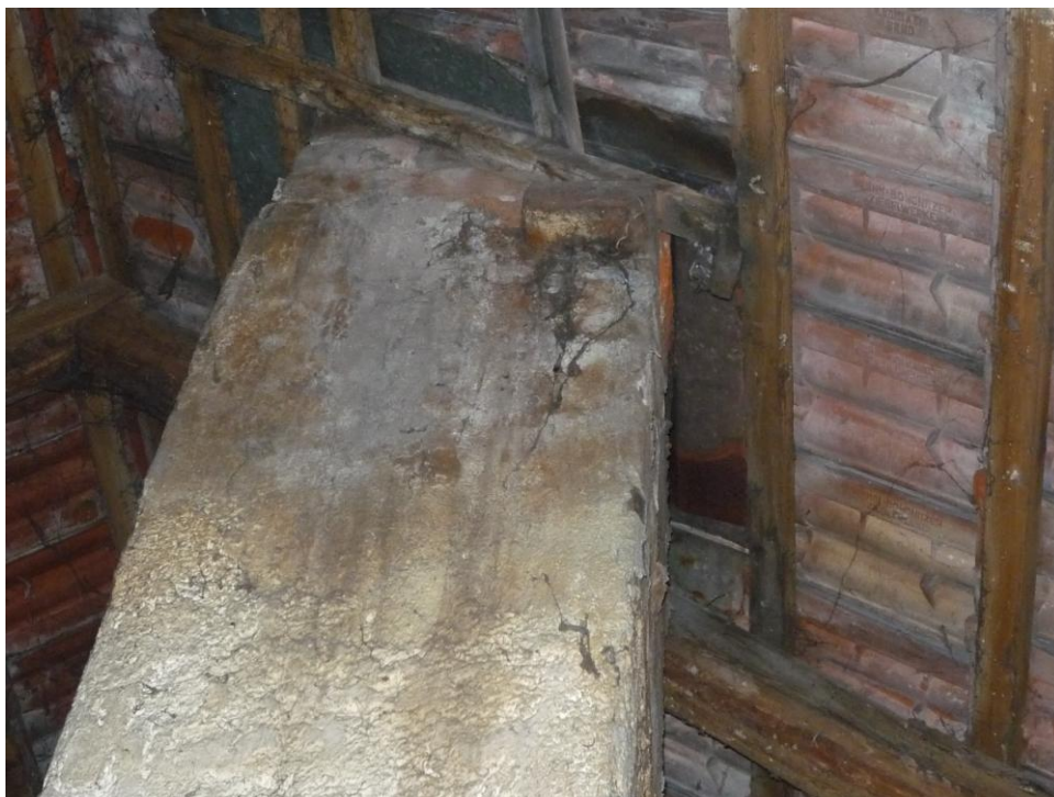
Příloha č. 15 Zkorodované oplechování komínů (Zdroj: autor, 2016)
