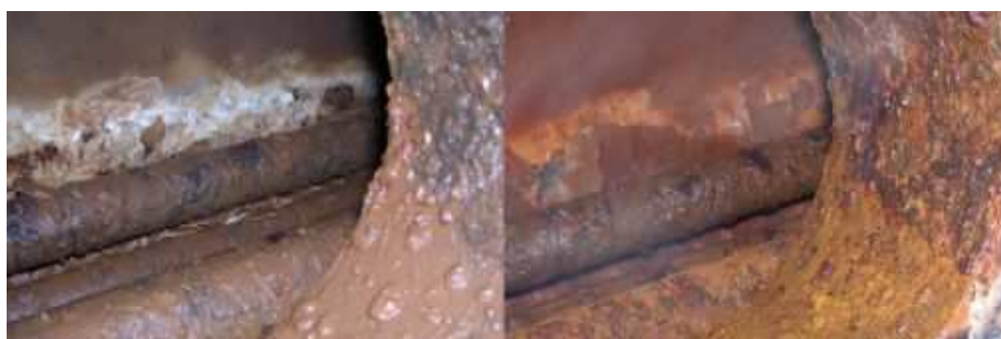
Obr. 7 Sedimentační nános a koroze na povrchu trubek [23]
