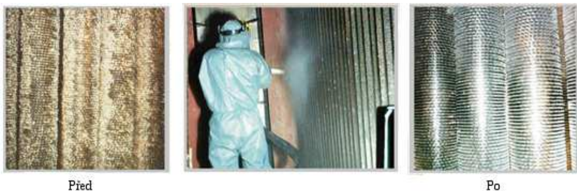
Obr. 15 Znečištěné žebrované trubky výměníku před a po čištění suchým ledem [25]
