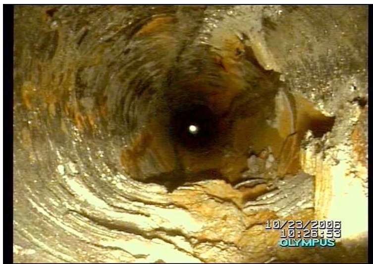
Obr. 3 Tvrdé nánosy na vnitřním povrchu trubky [23]
