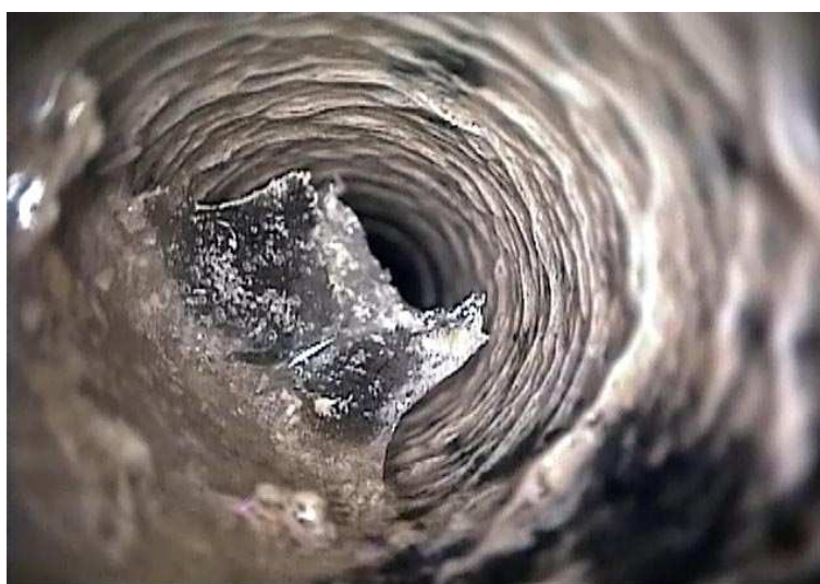
Obr. 4 Vnitřní povrch trubky kondenzátoru zanesený vrstvou ledu [23]
