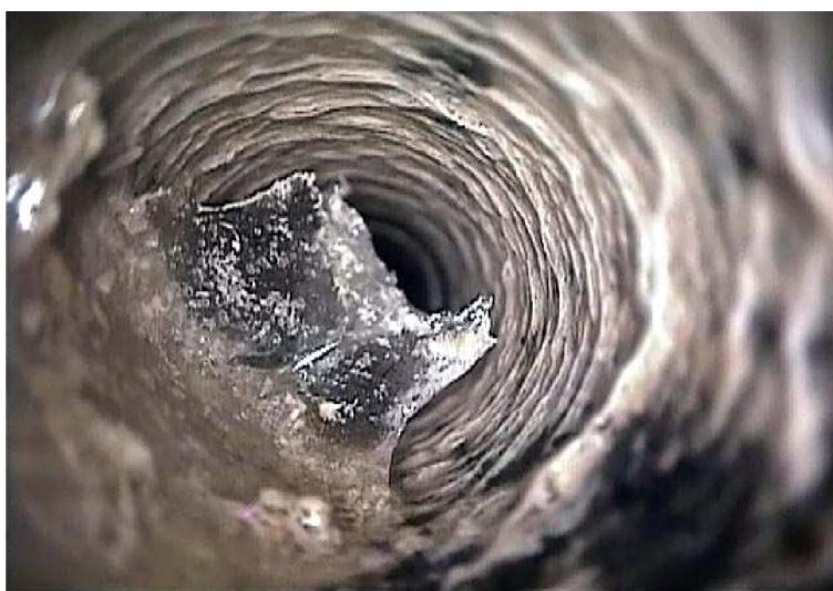
Obr. 4 Vnitřní povrch trubky kondenzátoru zanesený vrstvou ledu [23]
