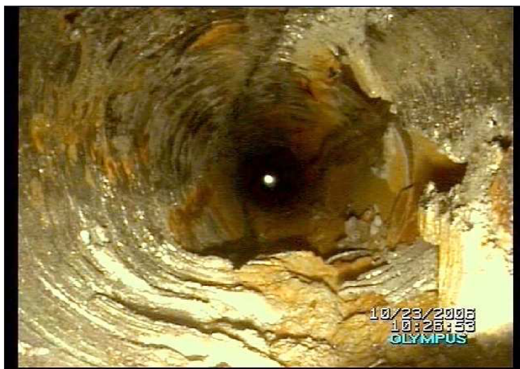
Obr. 3 Tvrdé nánosy na vnitřním povrchu trubky [23]
