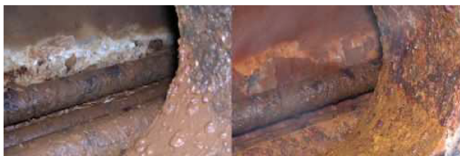
Obr. 7 Sedimentační nános a koroze na povrchu trubek [23]
