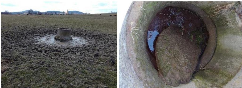
Obrázek č. 3: Nefunkční odvodňovací skruže
