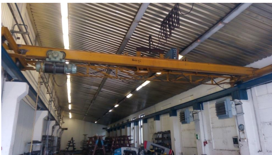
Obr. 18: Mostový jeřáb č. 1
