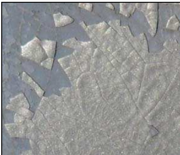
Obr. č. 4 – Popraskání [foto autor]
