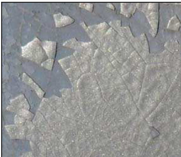
Obr. č. 4 – Popraskání [foto autor]
