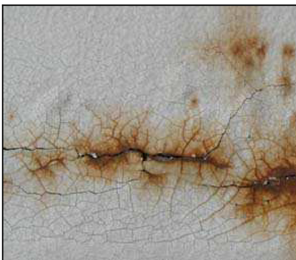
Obr. č. 6 – Koroze/rez [foto autor]
