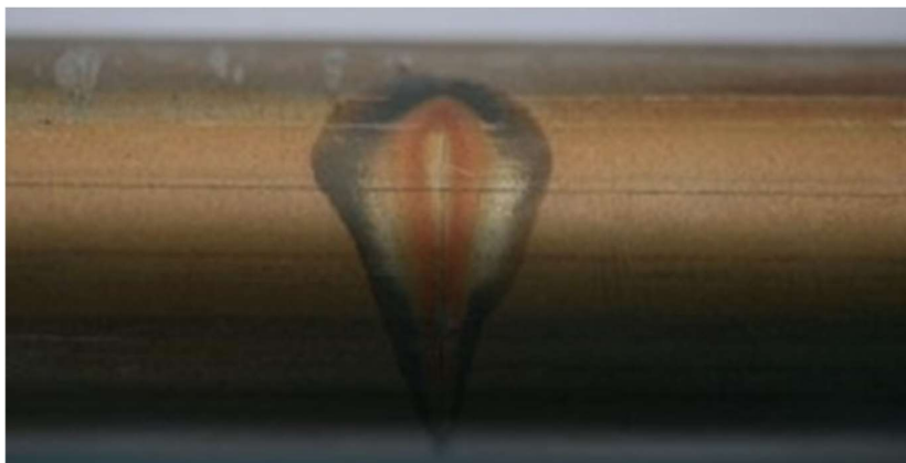
Obr. 13 – Část poškozené trubky [55]
