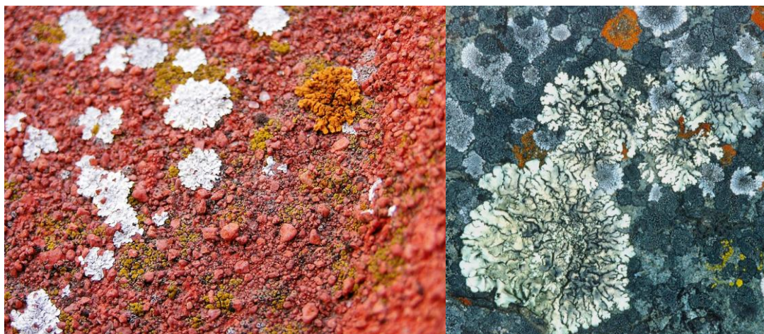
Obrázek 26 – Lišejník na fasádách zateplených budov [26]
