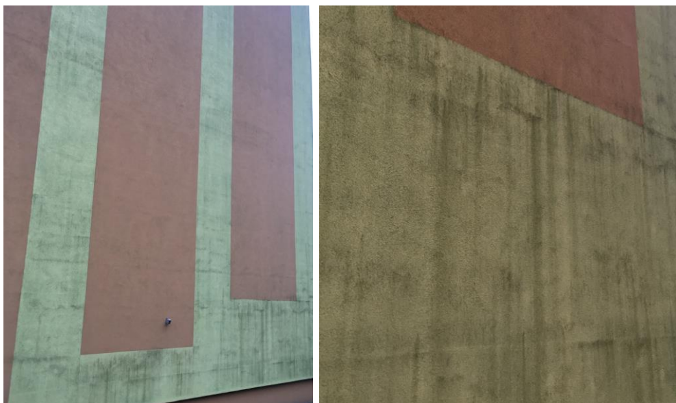
Obrázek 22 – Plísně na fasádách domů zateplených systémem ETICS
