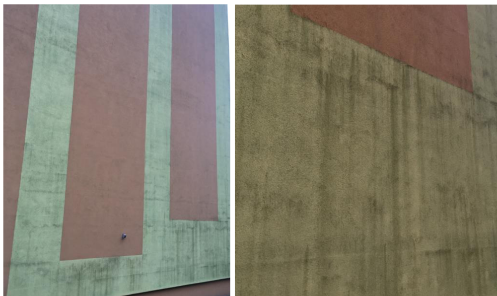
Obrázek 22 – Plísňe na fasádách domů zateplených systémem ETICS
