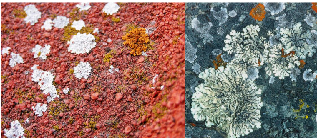
Obrázek 26 – Lišejník na fasádách zateplených budov [26]
