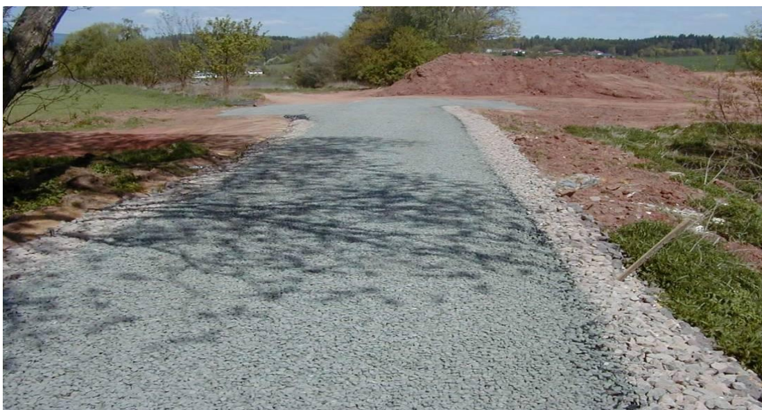
Foto č.11. Cesta VC 14, stav ke dni 7. 5 2007 (PŮ TRUTNOV, 2007)
