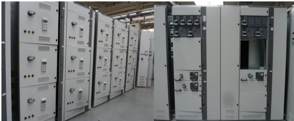
Blokové rozvaděčové pole
