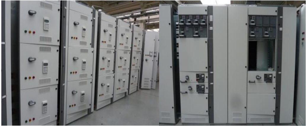
Blokové rozvaděčové pole
