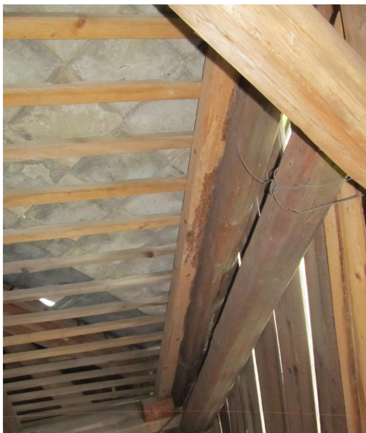
Foto č.9 Vyztužení krokve (I'D/K1)
