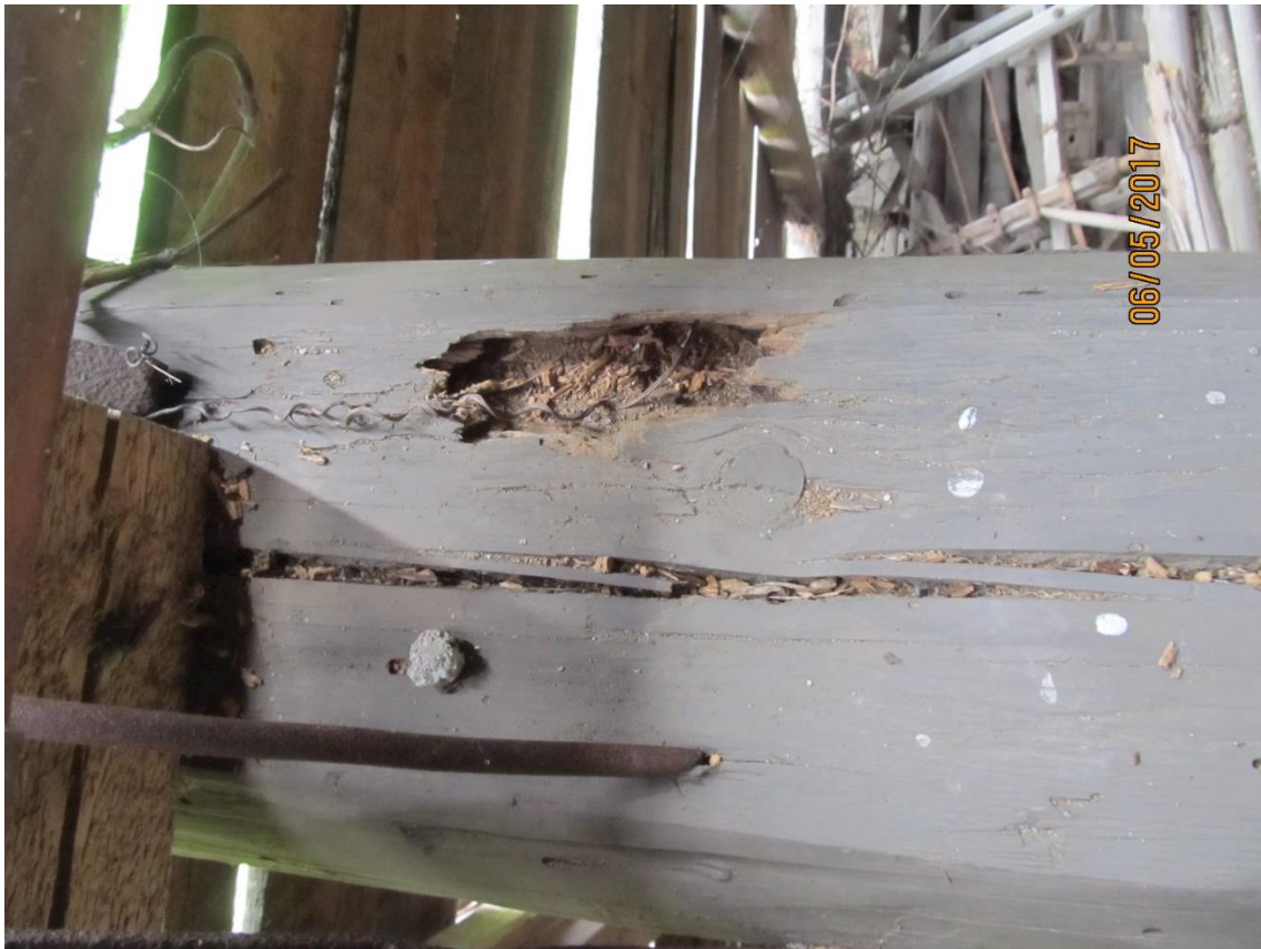
Foto č.10 Poškození prvku (SP1)
