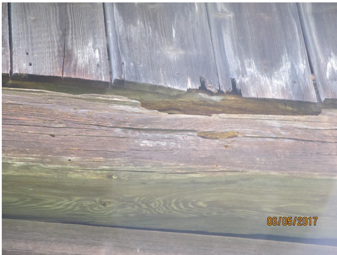
Foto č.7 Degradace průvlaku hnilobou (Z/Rs1)
