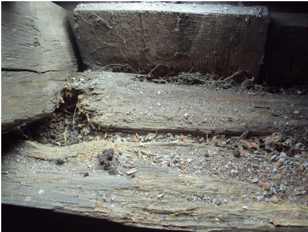
Obr. č 13 Poškození pozednice (III Z/P1)
