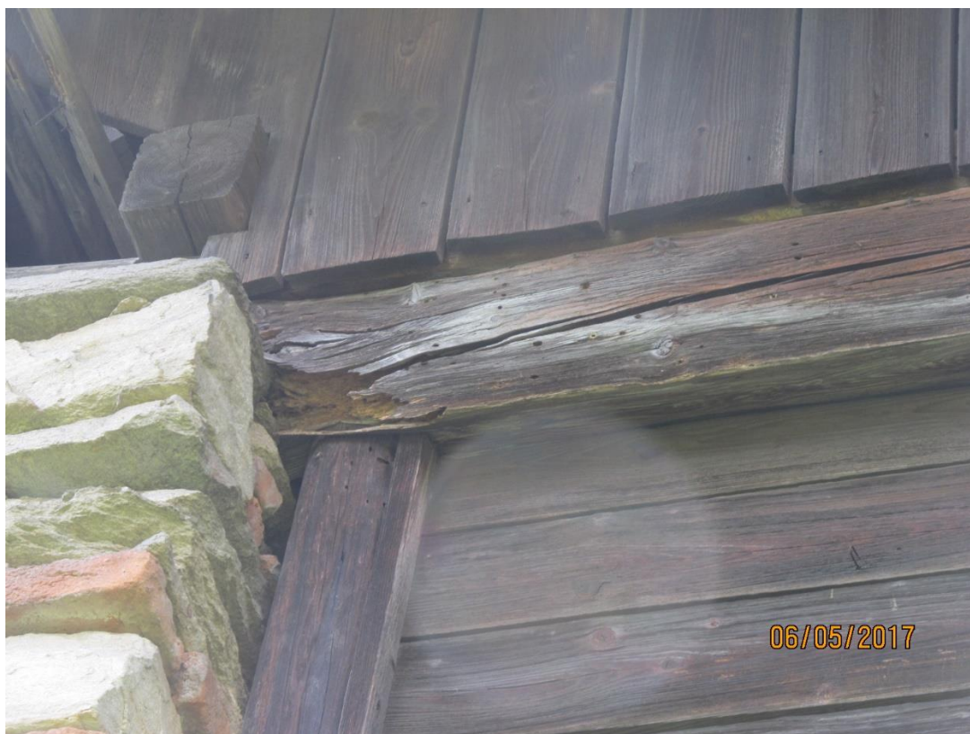
Foto č.6 Detail poškození (Z/Rs1)
