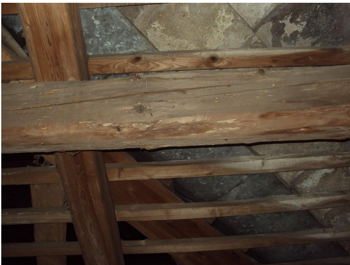
Foto č.13 Poškození vaznice (I'D/V1)
