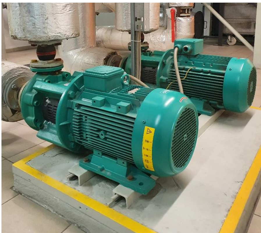
Obr. 15: Oběhová čerpadla v centrální výtopně (Foto autor, 2019)
