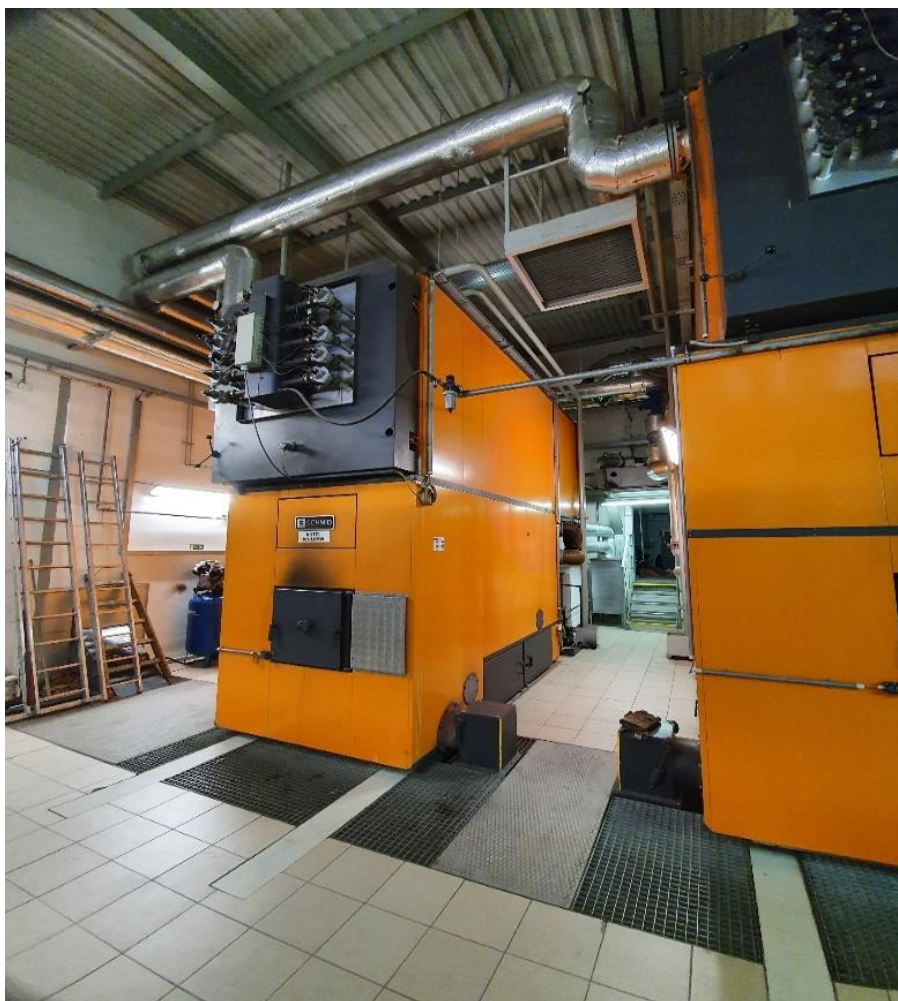
Obr. 14: Kotel K1 UTSR 1600.32 vlevo, ve variantě 1 určený k výměně (Foto autor, 2019)
