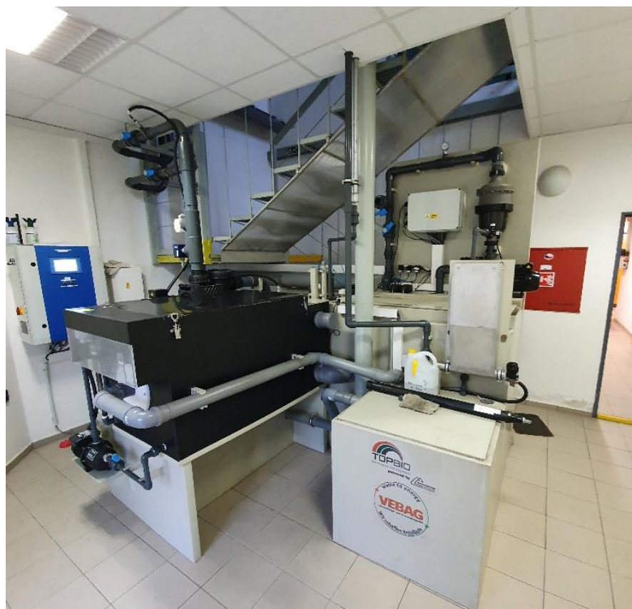
Obr. 13: Vnitřní filtrační jednotka mokré vypírky spalin (Foto autor, 2020)
