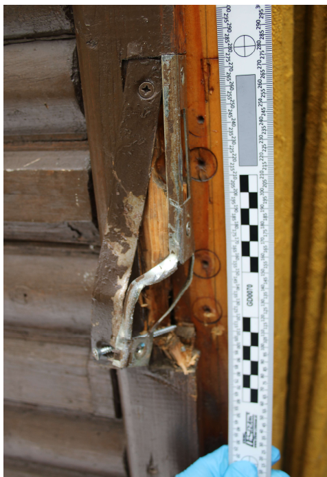
Obr. č. 33: Pohled na vypáčený zapadací plech zárubní vstupních dveří – vlastní obrázek. Zdroj: (kriminalistický spis KŘP Havlíčkův Brod).
