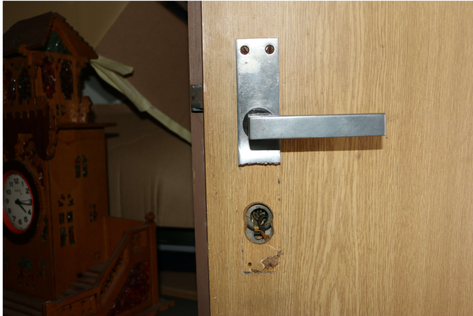
Obr. č. 28: Pohled na rozlomenou cylindrickou – vlastní obrázek. Zdroj: (kriminalistický spis KŘP Havlíčkův Brod).
