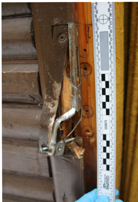
Obr. č. 33: Pohled na vypáčený zapadací plech zárubní vstupních dveří – vlastní obrázek. Zdroj: (kriminalistický spis KŘP Havlíčkův Brod).
