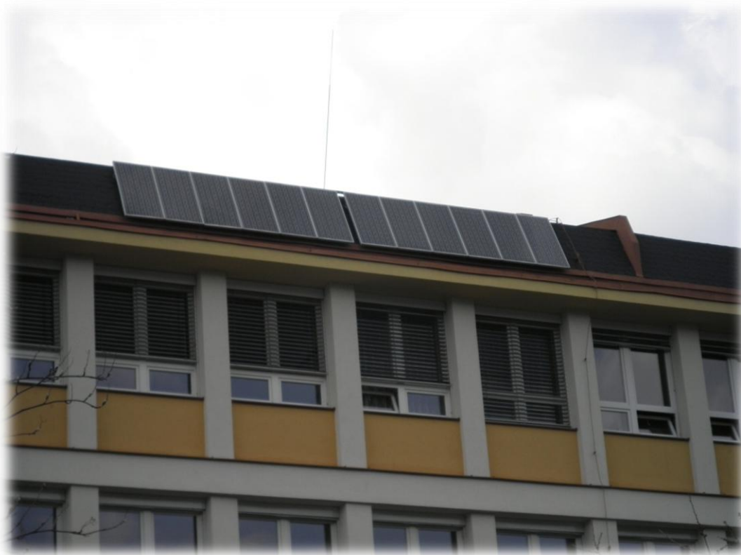
Obrázek 9: (Špička, 2010) Fotovoltaické panely na střeše gymnázia – detailní záběr
