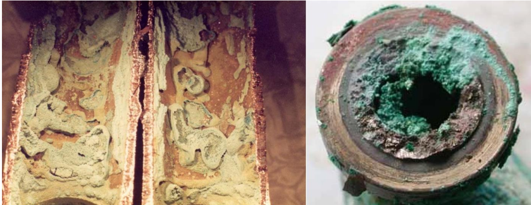
Obrázek 4: Koroze v měděné trubce při dlouhodobém působení měkké vody
