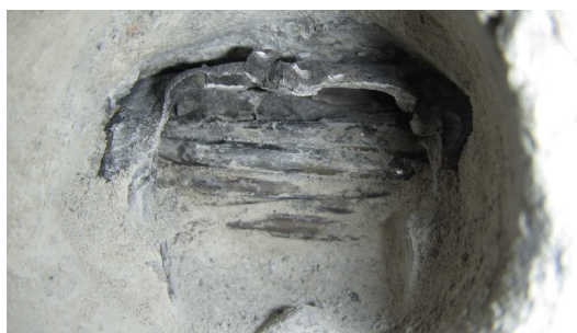
Obrázek P3. 40: Detail stavu zainjektování kabelového kanálku na sondě K-10
