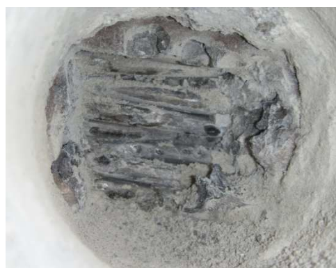
Obrázek 40: Detail stavu předpínací výztuže a proinjektování kabelového kanálku [42]
