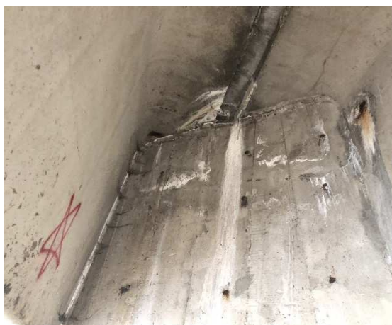
Obrázek 32: Detail vápenných výluh v pracovní spáře mezi monolitickým příčnickem a mostními nosíky [41]
