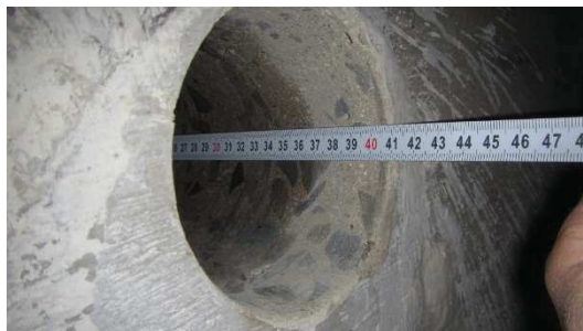
Obrázek P2. 44: Hloubka provedeného jádrového vývrtnu VO4
