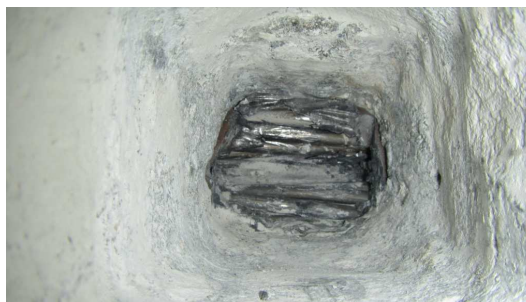
Obrázek P3. 12: Detail stavu zainjektování kabelového kanálku na sondě K-3
