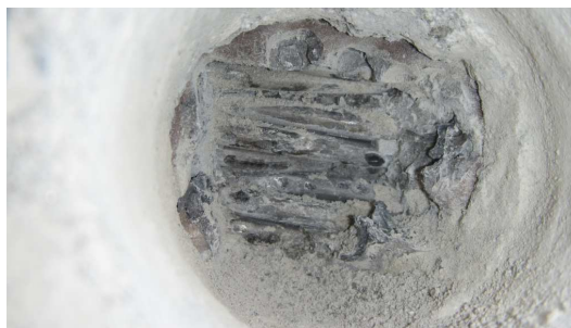
Obrázek P3. 28: Detail stavu zainjektování kabelového kanálku na sondě K-7
