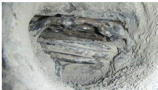
Obrázek P3. 32: Detail stavu zainjektování kabelového kanálku na sondě K-8
