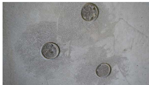
Obrázek P2. 38: Makrotextura betonu po provedené odtrhové zkoušce – u všech tří zkušební vzorků došlo k porušení v podkladu
