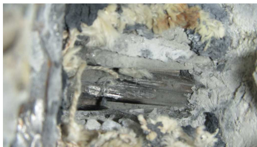
Obrázek P3. 24: Detail stavu zainjektování kabelového kanálku na sondě K-6
