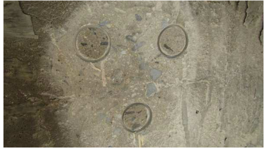
Obrázek P2. 52: Makrotextura betonu po provedené odtrhové zkoušce – u všech tří zkušební vzorků došlo k porušení v podkladu
