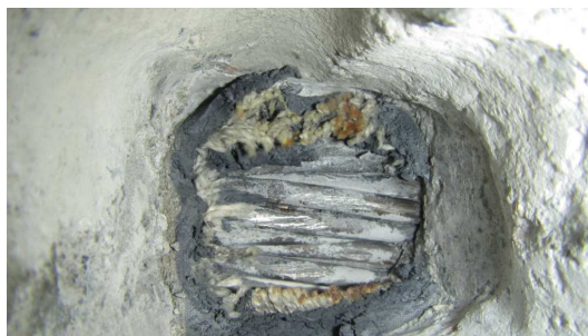
Obrázek P3. 20: Detail stavu zainjektování kabelového kanálku na sondě K-5
