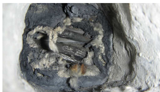
Obrázek P3. 36: Detail stavu zainjektování kabelového kanálku na sondě K-9
