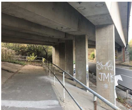
Obrázek 26: Nosná konstrukce mostu z mostních prefabrikátů DS-C [41]
