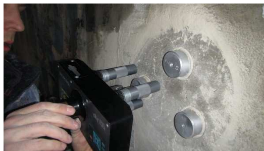
Obrázek P2. 48: Provádění odtrhové zkoušky pomocí automatického trhacího přístroje Proceq DYNA DY-16
