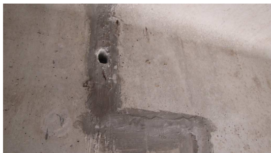
Obrázek P3. 17: Pohled na zkušební místo na ozubu nosníků (sonda K-5)
