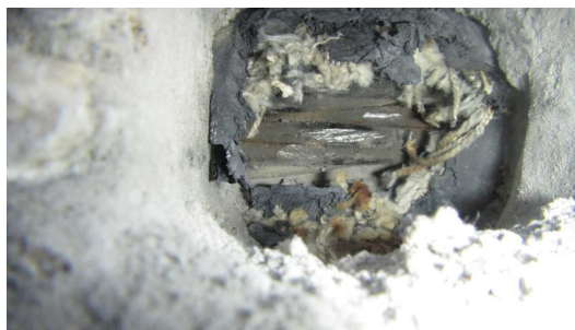
Obrázek P3. 16: Detail stavu zainjektování kabelového kanálku na sondě K-4
