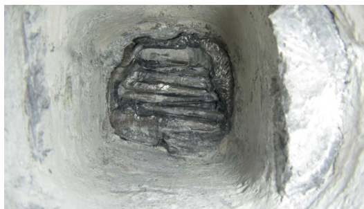
Obrázek P3. 8: Detail stavu zainjektování kabelového kanálku na sondě K-2
