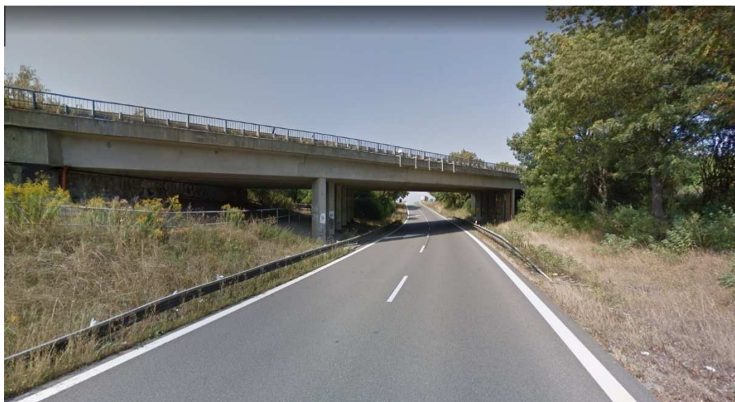
Obrázek 24: Celkový pohled na pravou stranu mostu ev. č. 43-011 ve směru na Kuřim z odbočné větve MÚK [39]
