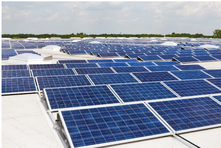
Obrázek 14: Pole solárních panelů (převzato z [16])
