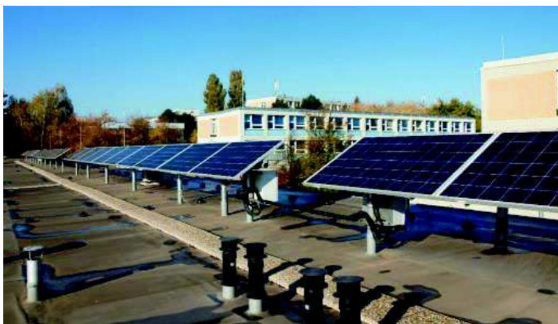
Obr. 35: FVE v Praze na střeše Technické fakulty ČZU s pevnými stojany, panely jsou orientovány směrem na jih pod úhlem 35^\circ
