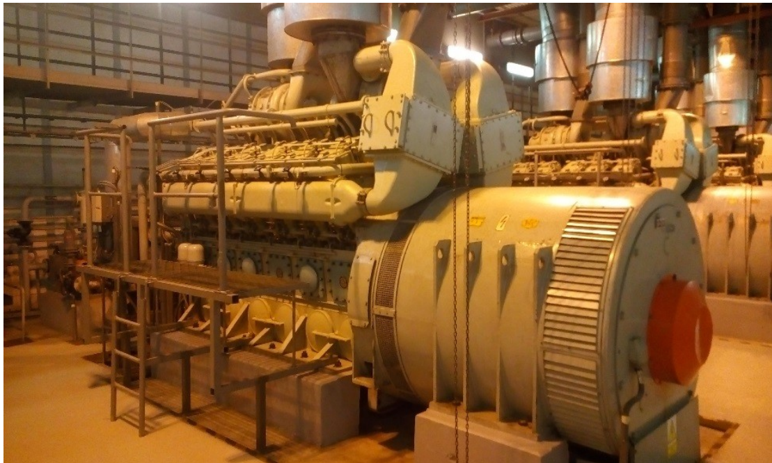
Obr. 39: Záložní diesel generátor umístěný ve stanici pražského metra Radlická Zdroj: Vlastní práce autora
