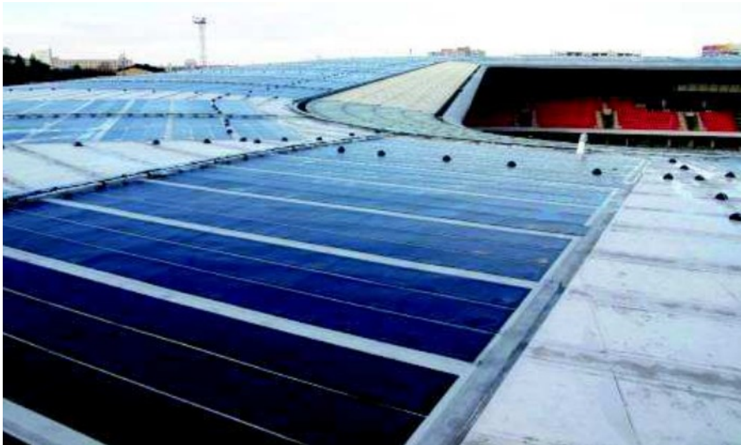
Obr. 36: FVE v Praze umístěné na střeše fotbalového stadionu, FV fólie jsou umístěné téměř horizontálně bez podpěrných stojanů
