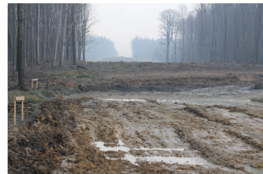
Obr. č. 43. / Výstavba přeložky silnici I/11 v Oldřichovicích u Třince. Ukrojí zase nějaký ten kus krajiny. Kolik takových bude ještě potřeba?
