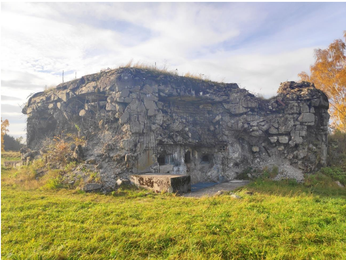
Obr. 14: Značně rozdrolený beton na týlové stěně K-Bg-S 10, v místech zásahů.
