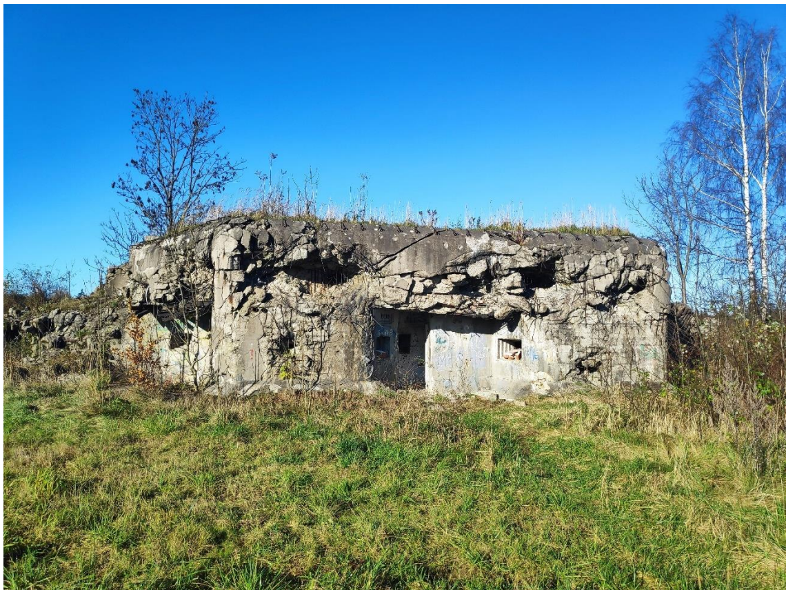
Obr. 26: Značně poškozený, posprejovaný a zarostlý K-S 17.
