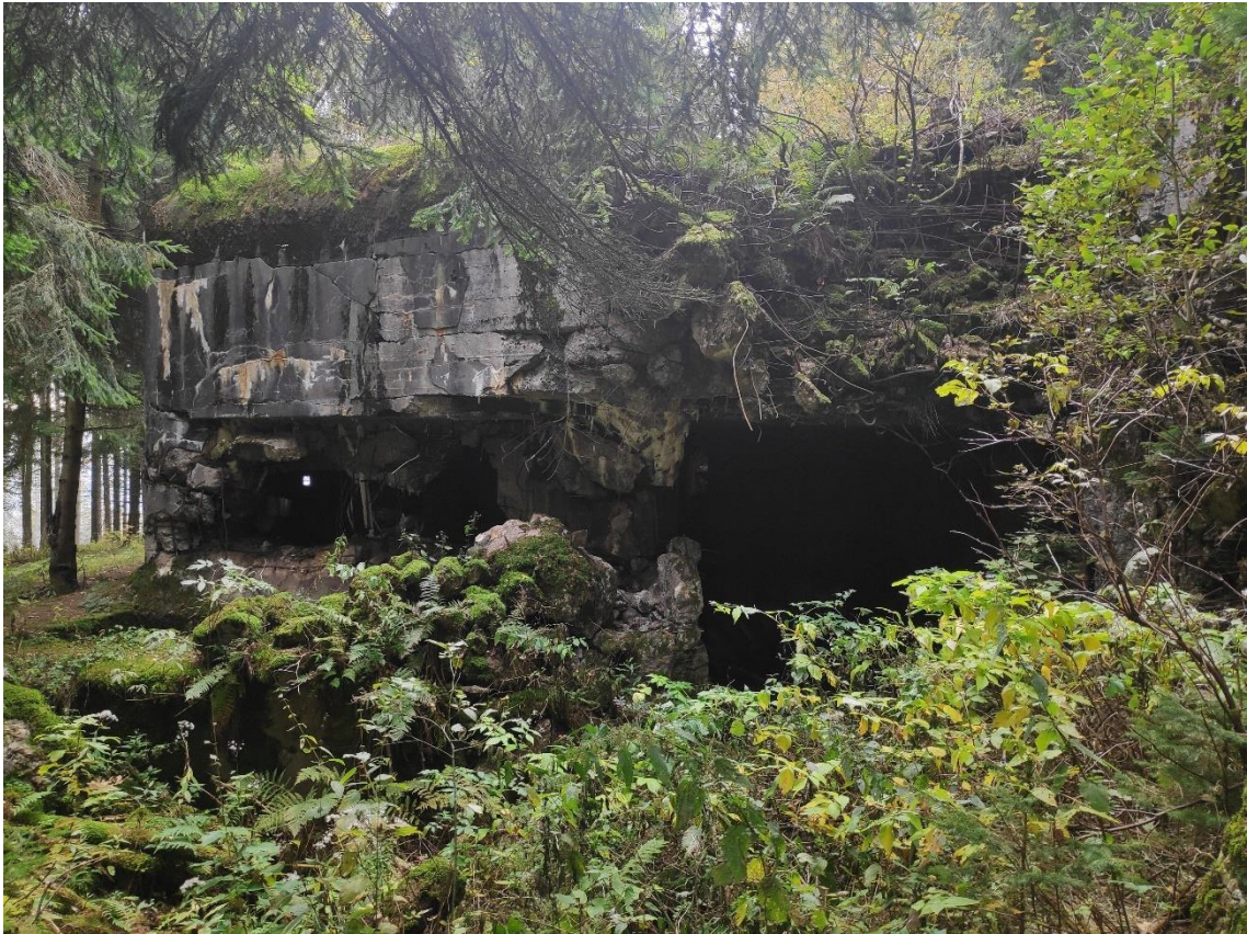
Obr. 3: Značně poškozená stěna střelecké místnosti objektu K-S 2.
