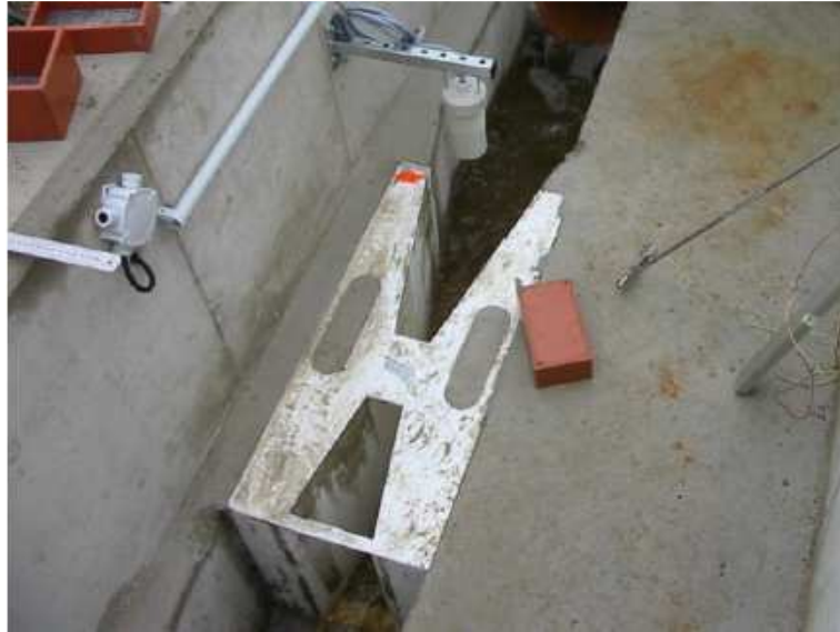
Obr. 4 Protiproudňní pohled na Parshallův žlab s ultrazvukovým hladinoměrným snímačem, fotodokumentace LVV
