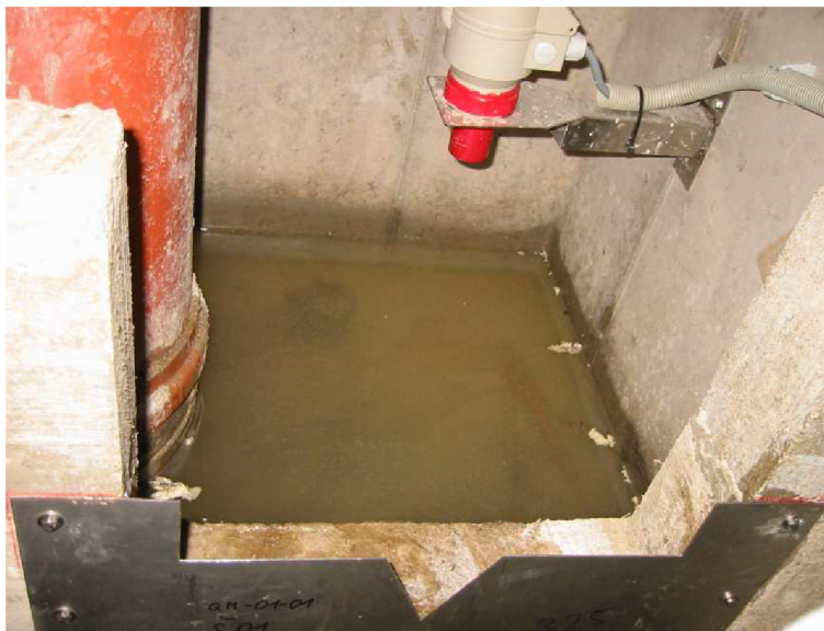
Obr. 1 Protiproudí pohled na kombinovaný přeliv pro měření průsaků drenážním systémem a hladinoměrný snímač, fotodokumentace LVV
