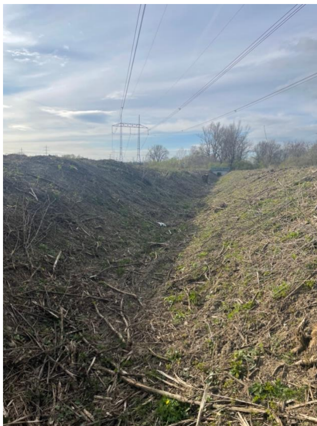
Obr. 11: Koryto potoka Libuška za antropogenně vybudovanou hrází, foto: autor, únor 2024
