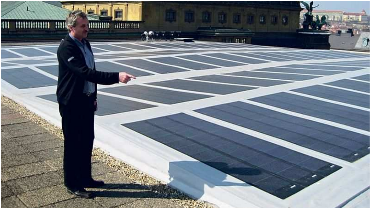
Příloha č. 10: Solární panely na střeše Národního divadla (zdroj: Vít Hnízdil, Právo)
