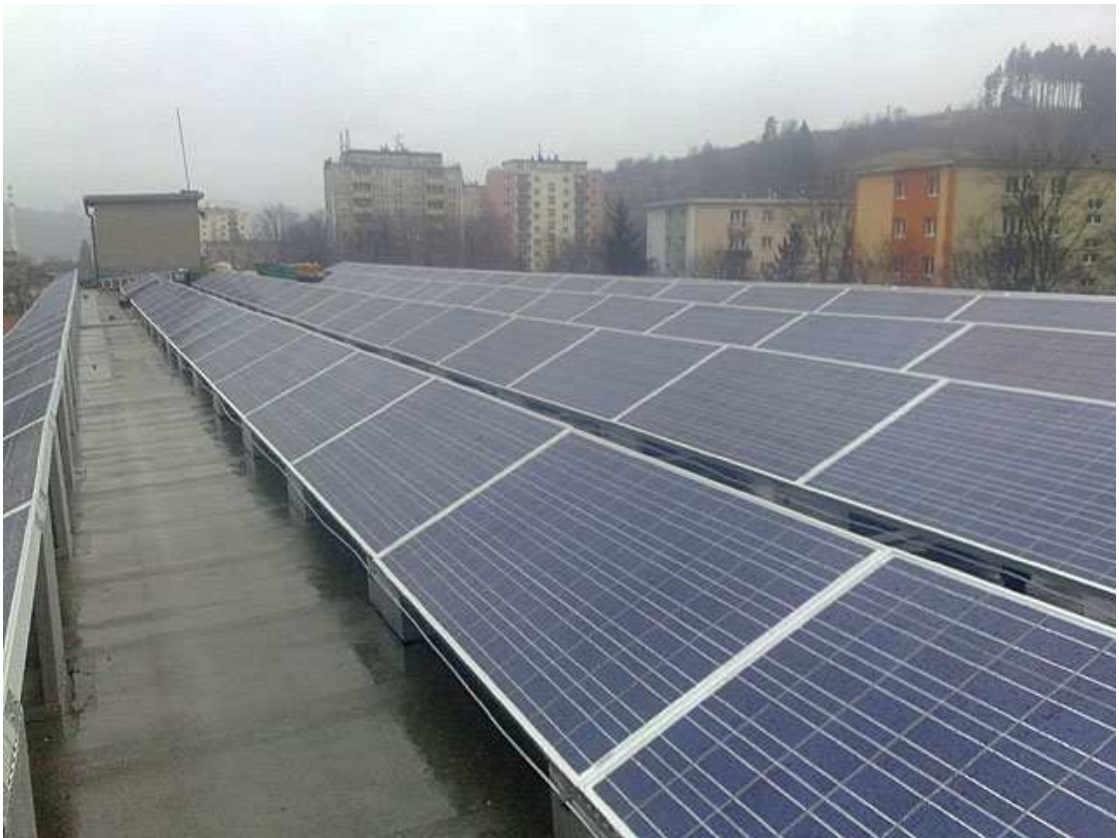
Příloha č. 12: FVE na ploché střеше (zdroj: http://www.degcz.cz/reference )
