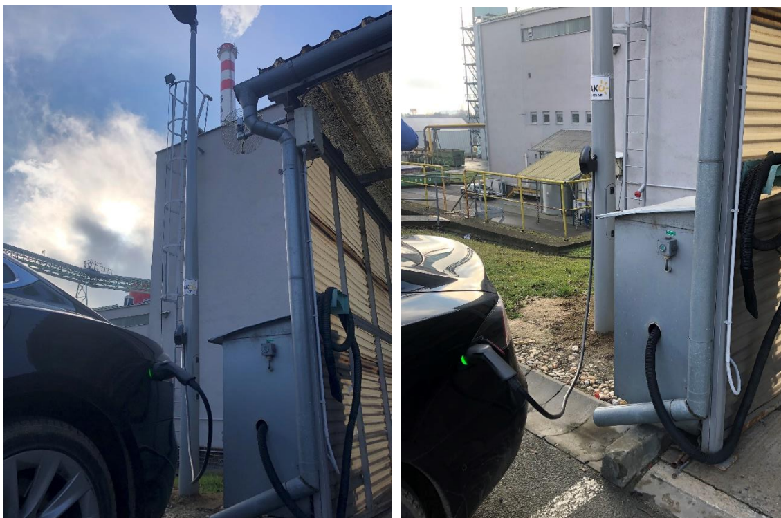
Obrázek 4.3 Realizace svítidla v plně integrovaným nabíjecím bodem 22 kW v areálu SAKO Brno
