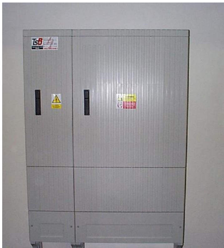
Obrázek 7.2 Zapínací rozvaděč veřejného osvětlení [63]
