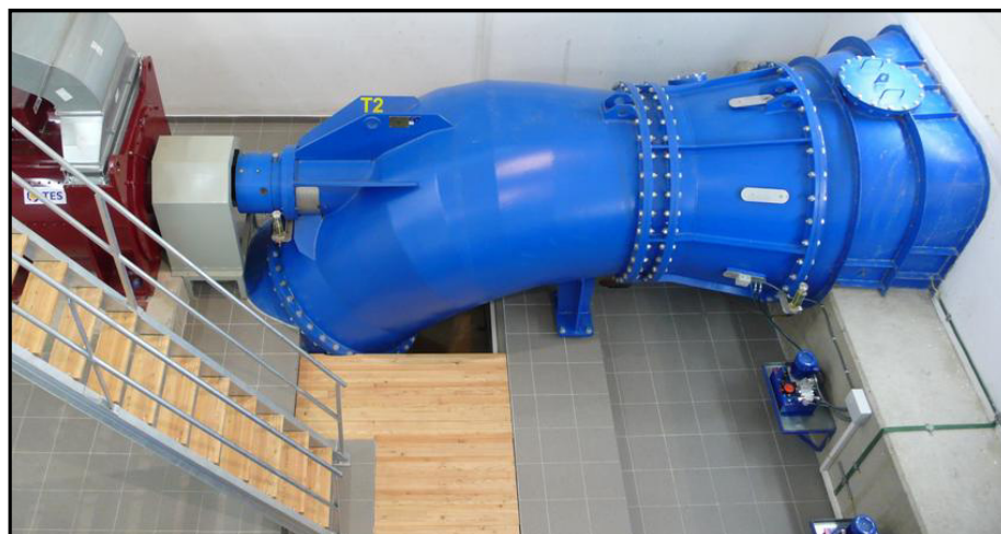
Obr. 6.5 – Turbína typu Semi-Kaplan od společnosti HYDROHRM
