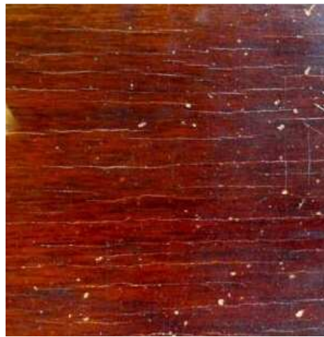
Obrázek 44 - Popraskaný NF (makrotrhliny)
