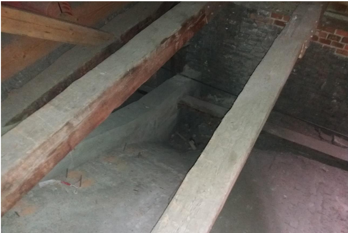
35. Brno, kostel sv. Josefa u kláštera františkánek, 1651–1653, rub klenby, vybetonovaný klenební pas, podélné dřevěné a kovové táhlo.
