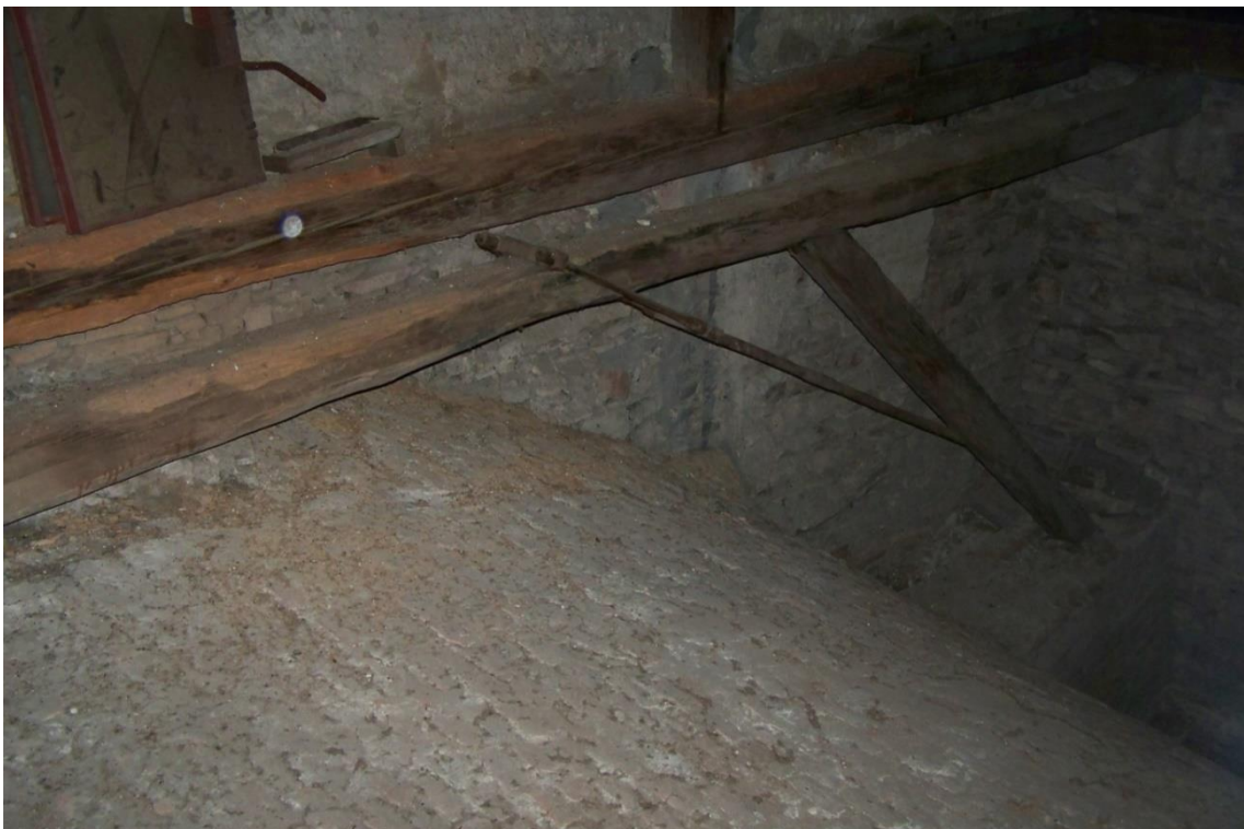
15. Bojkovice, kostel sv. Vavřince, 1651–1656, podkroví, detail systému táhel na rubu klenby v místě styku lodi s presbytářem.
